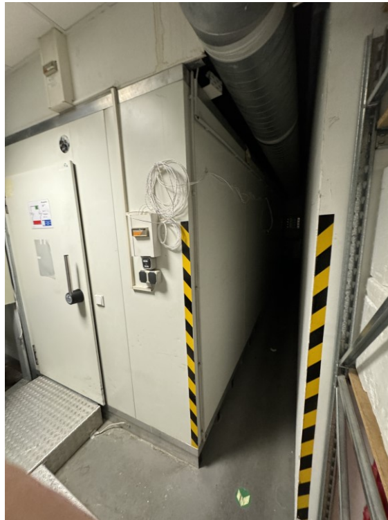
Foto Nr. 4 Kühlzelle im „Zwischengeschoss“
