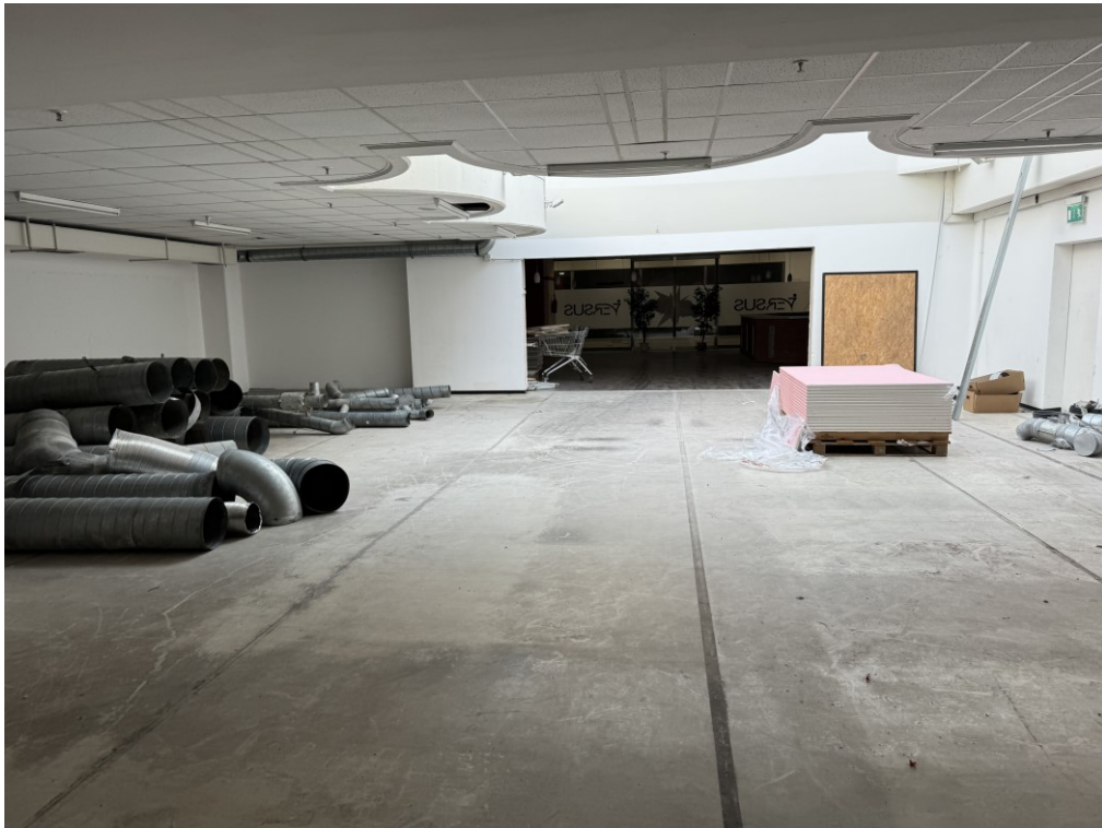
Foto Nr. 3 Fläche Shop 22 1. OG mit fehlender Trennwand
