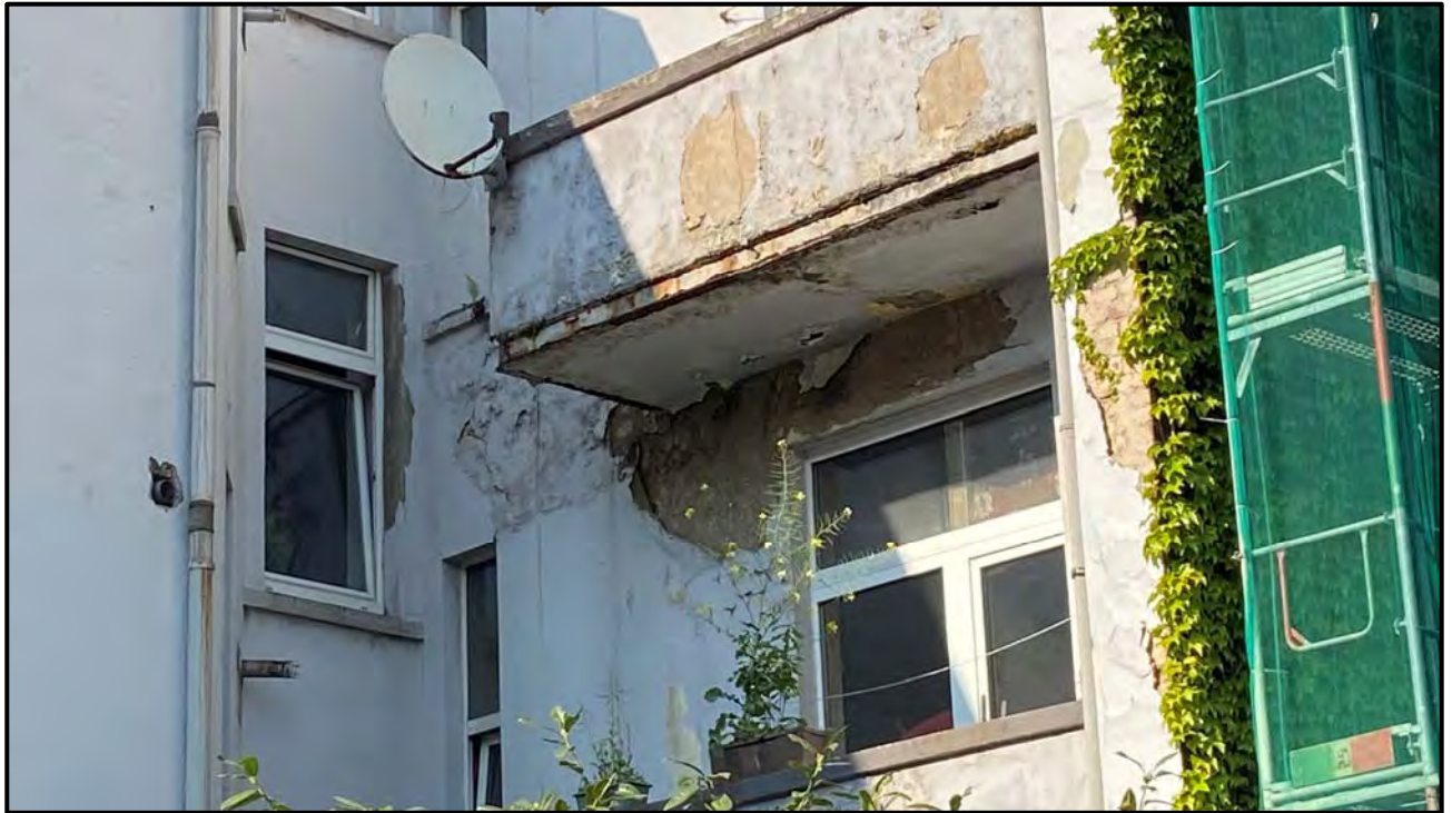
Mängel und Schäden an der Außenfassade
