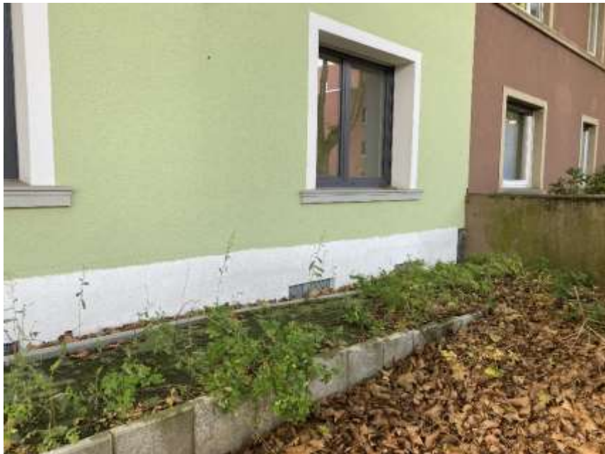
Bild 10: verwilderter barrierefreier Zugang
