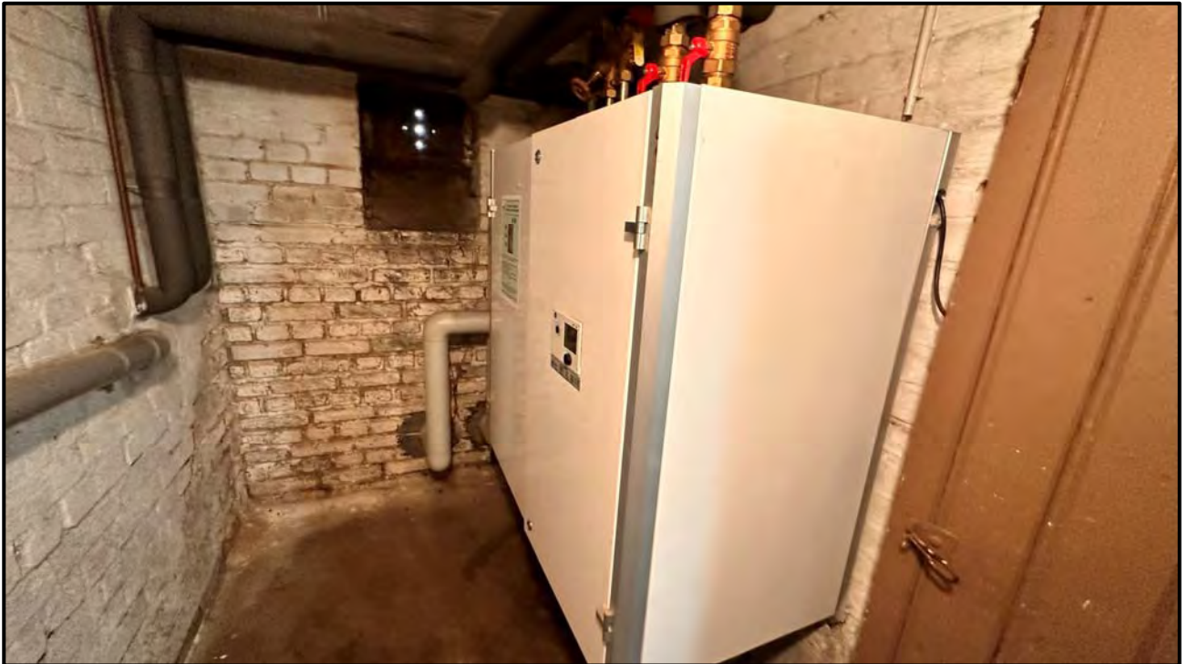
Heizungskellerraum mit Fernwärmeübergabestation
