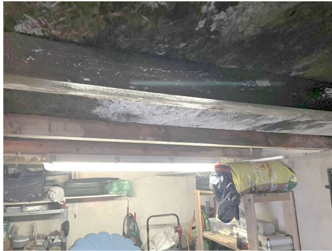
Holzbalkendecke Gartenhaus mit Feuchtigkeitserscheinungen
