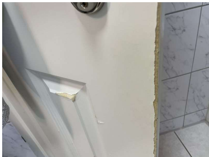
Türschaden im Bad
