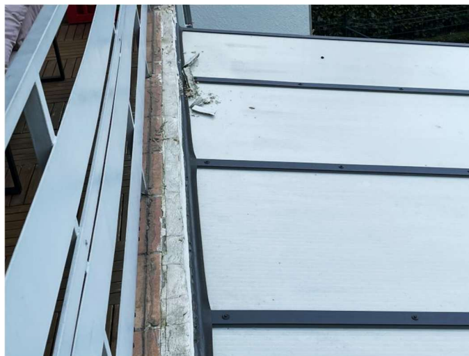
Schaden am Loggiaboden
