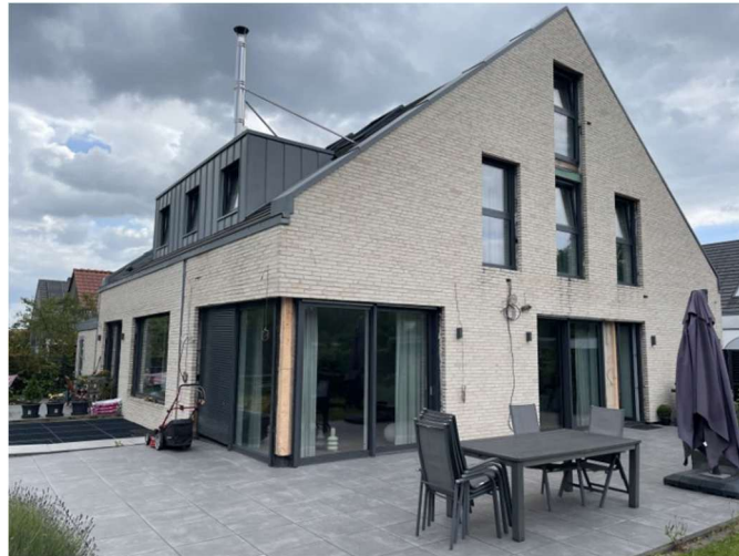
Fertigstellungsbedarf Fensterlaibungen und Klinker
