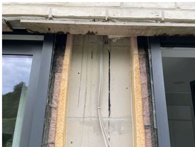
Fertigstellungsbedarf Fensterlaibungen und Klinker
