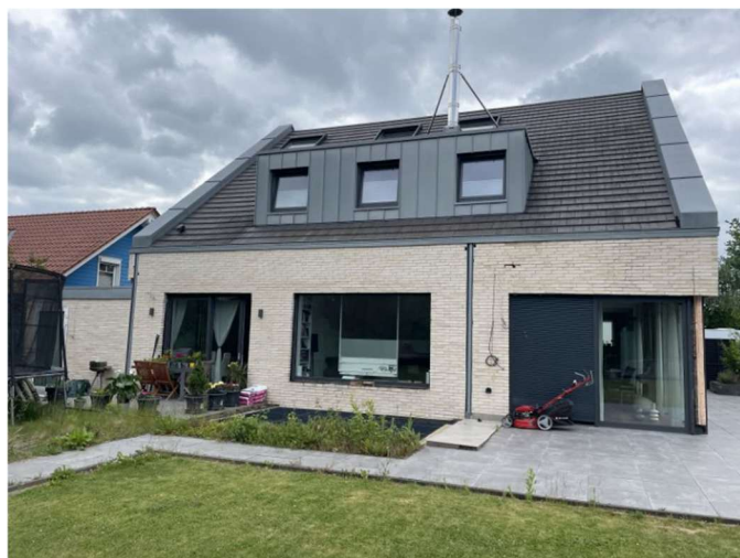
Fertigstellungsbedarf Fensterlaibungen und Klinker
