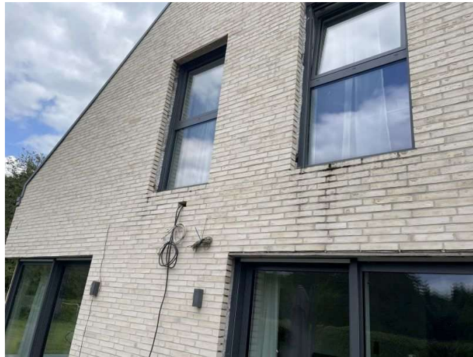
Fertigstellungsbedarf Fensterlaibungen und Beleuchtung
