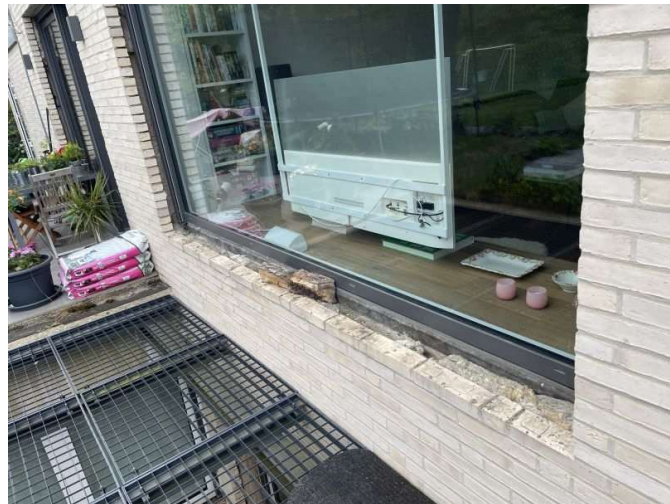
Fertigstellungsbedarf Fensterlaibungen, Lichtschachtumrandung
