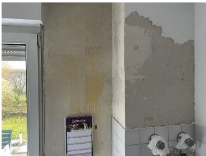
Küche - Außenwand mit Feuchtigkeiterscheinungen
