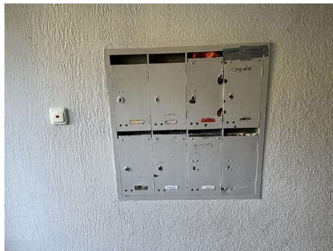
Briefkastenanlage im Treppenhaus
