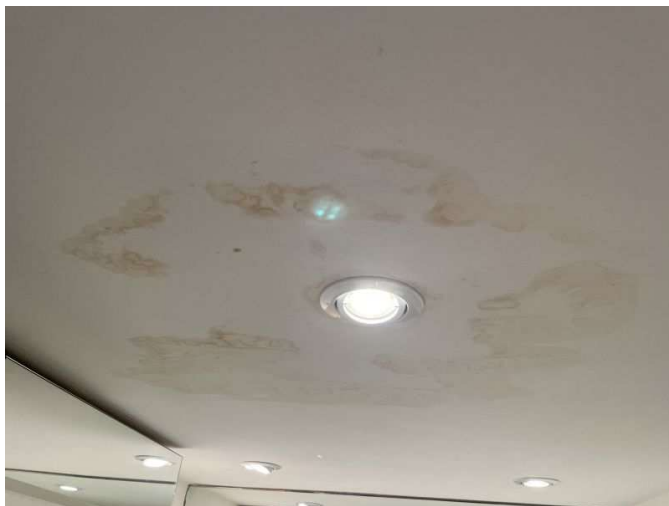
Decke im Kellergeschoss mit Feuchtigkeitserscheinungen
