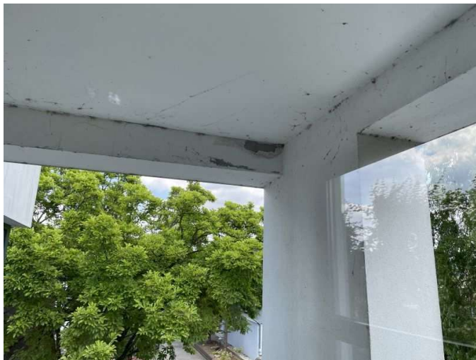
Feuchtigkeitserscheinungen im Hauseingangsvorbau
