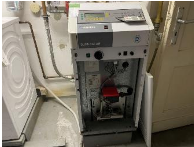
Gastherme im Kellergeschoss
