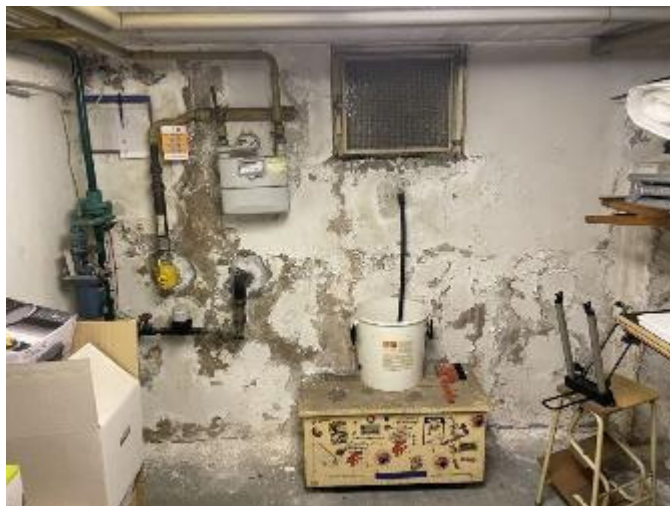
Hausanschlussraum im Kellergeschoss
