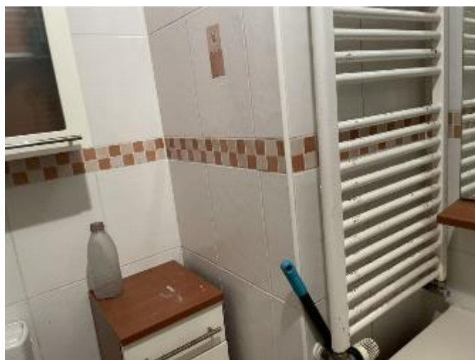
Handtuchheizkörper mit Roststellen
