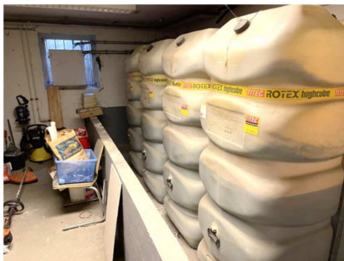
Heizöltanks im KG
