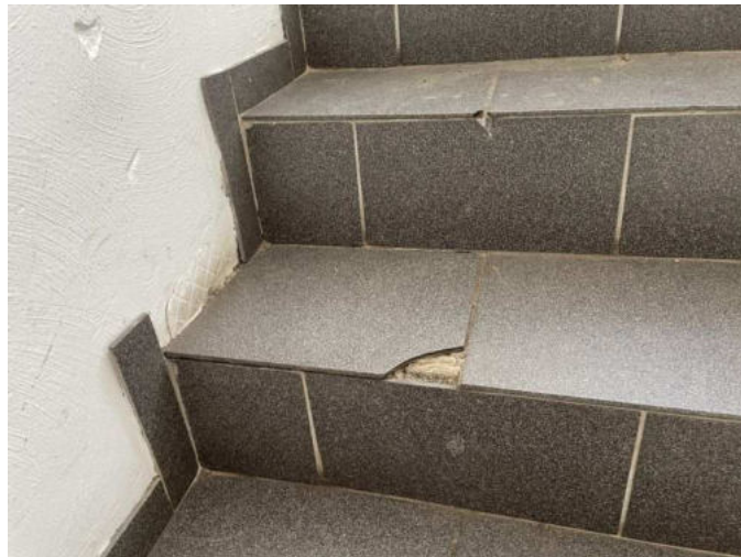
Instandsetzungsbedarf im Treppenhaus
