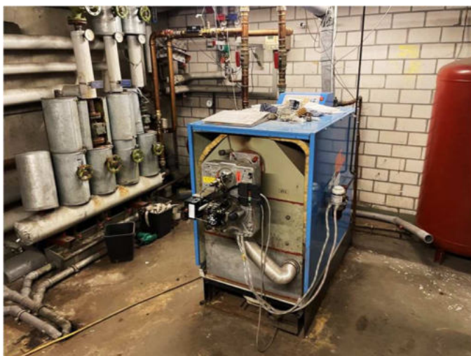
Heizungsanlage im KG
