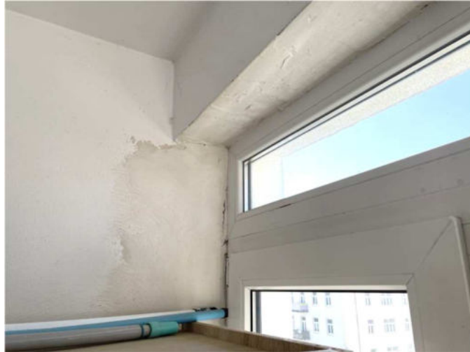
Instandsetzungsbedarf im Treppenhaus
