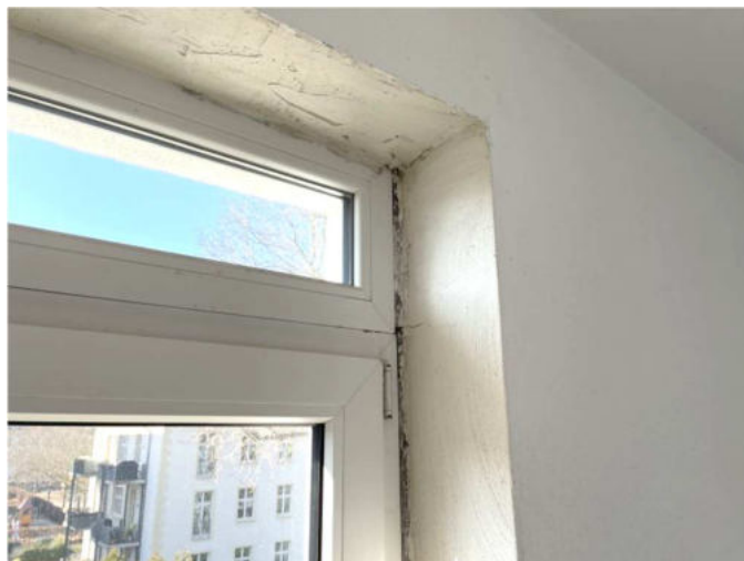
Instandsetzungsbedarf im Treppenhaus
