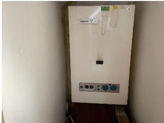
Gastherme im Dachgeschoss
