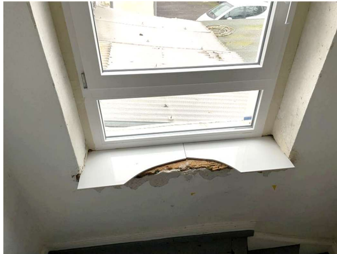
Schaden im Treppenhaus
