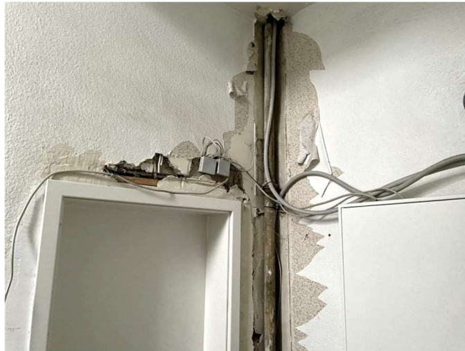
Fertigstellungsbedarf im Treppenhaus
