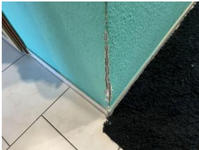
Schäden in einer Wohnung Mülhauser Straße 4
