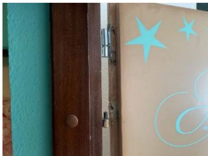
Schäden in einer Wohnung Mülhauser Straße 4
