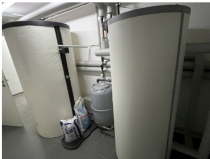
Heizung Mülhauser Straße 4 a
