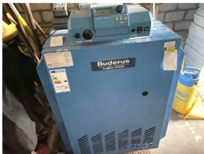
Heizung Mülhauser Straße 4
