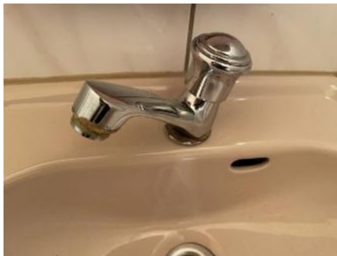
Schäden in einer Wohnung Mülhauser Straße 4
