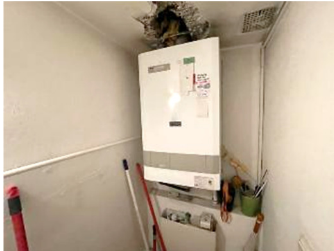
Gastherme, Instandsetzungsbedarf im Deckenbereich
