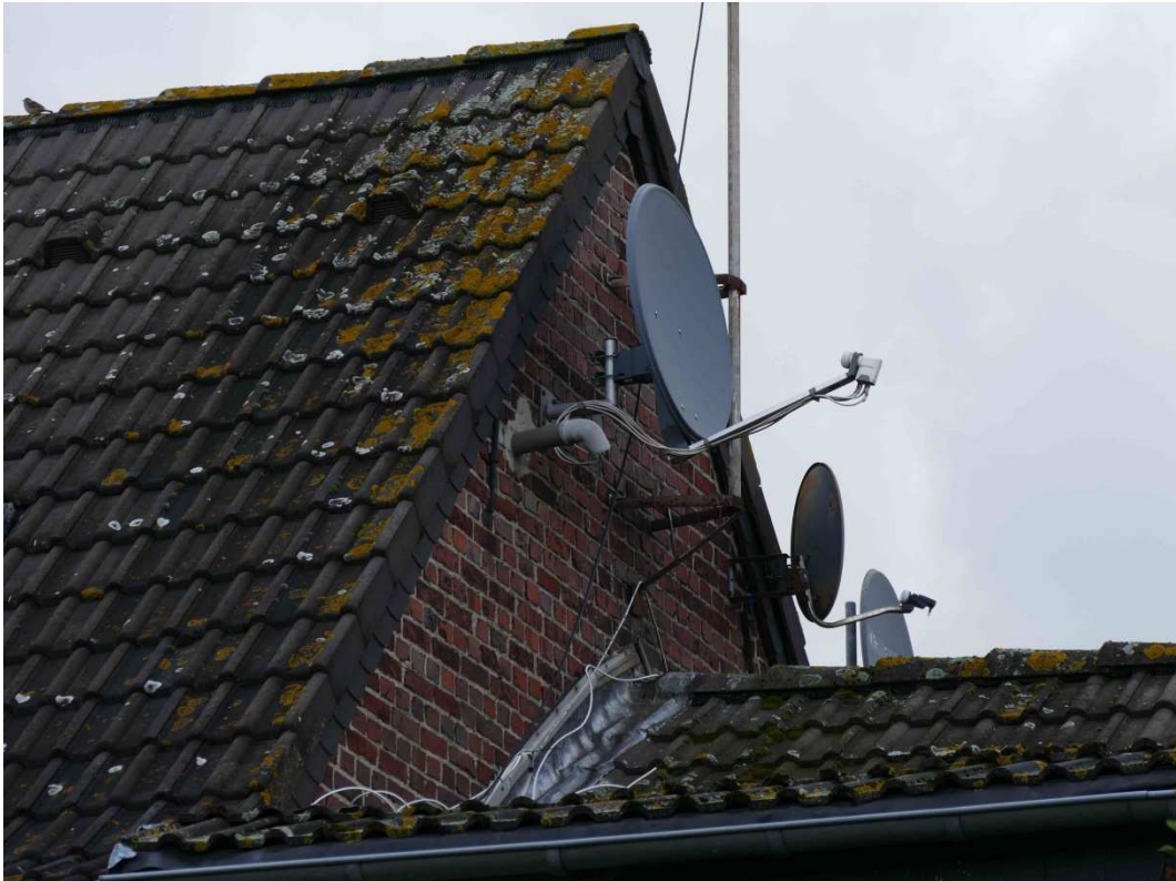
Bild 8: Antennenanlagen im Luftraum über Nachbargrundstück
