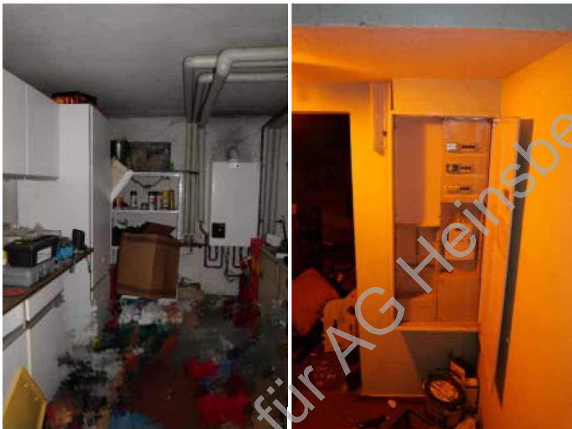
Heizung / Zähler Kellergeschoss
