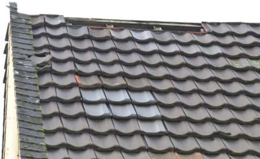
Bild 13: Detailansicht der fehlenden Dachpfannen
