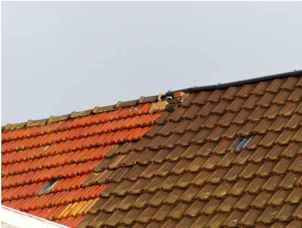
Bild 16: Detailansicht Dacheindeckung, Fehlstellen
