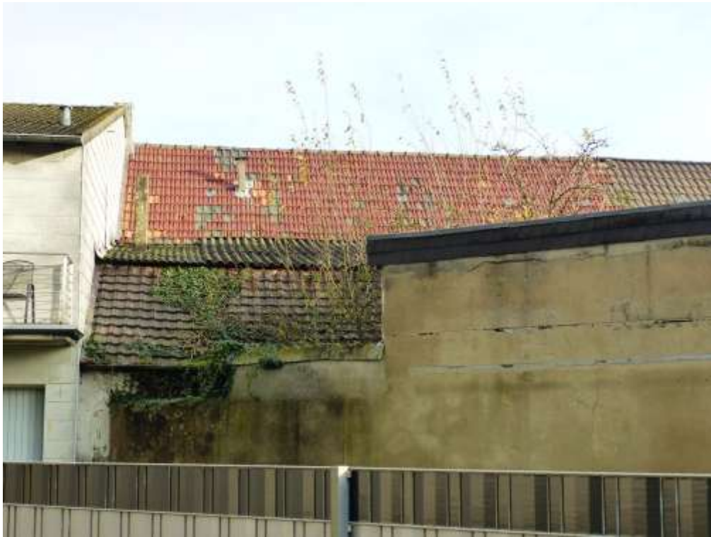
Bild 18: Übersichtaufnahme der maroden Dachflächen
