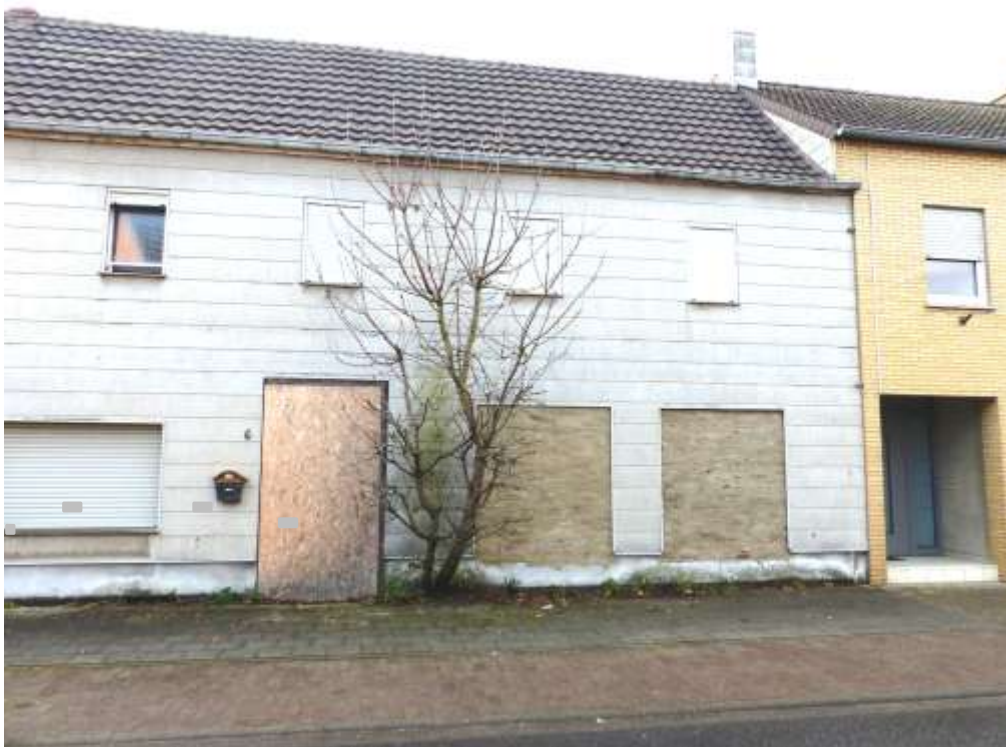
Bild 2: wie vor, Detailansicht
