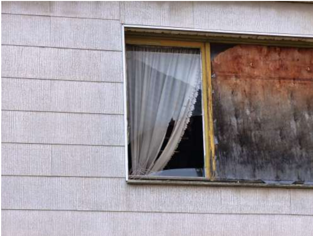
Bild 12: Detailansicht der zerbrochenen Fensterscheiben
