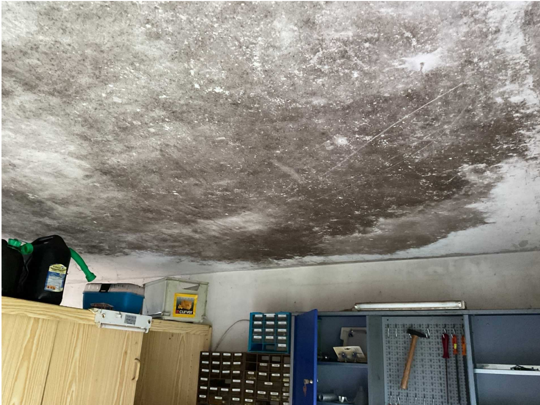
Bild 4: Auffeuchtung Garagendecke im hinteren Bereich
