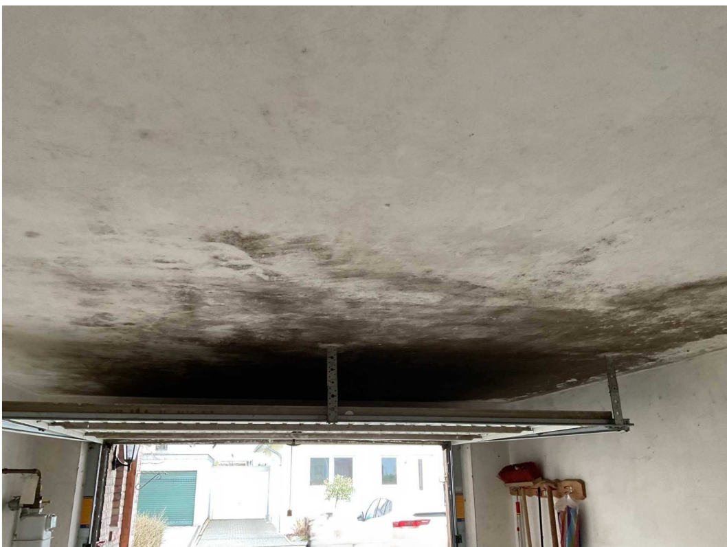
Bild 5: Auffeuchtung Garagendecke im vorderen Bereich
