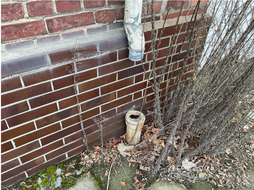
Bild 4: Fehlender Abschluss Regenfallrohr Straßenseite
