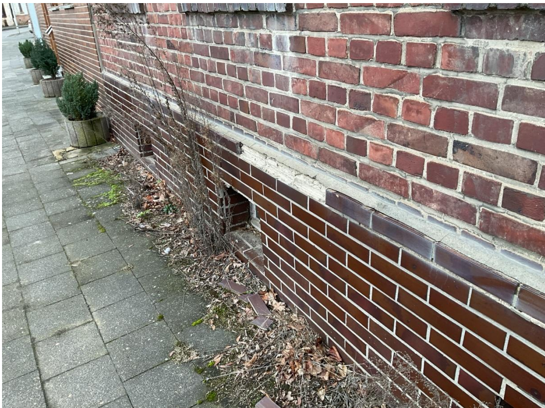
Bild 5: Beschädigungen Sockelmauerwerk Straßenseite
