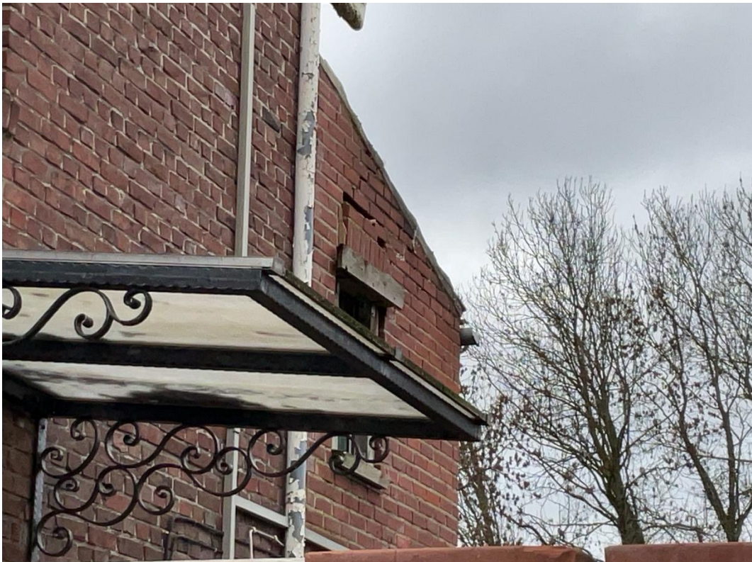
Bild 3: Risse im Mauerwerk des Sturzes Fenster Anbau OG
