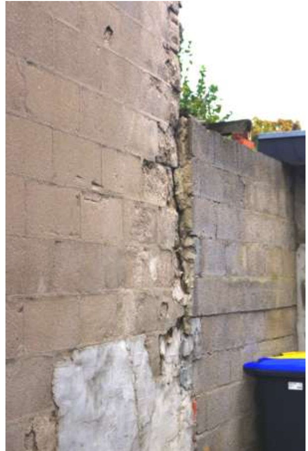
Bild 36: Ansicht der beschädigten Außenwand
