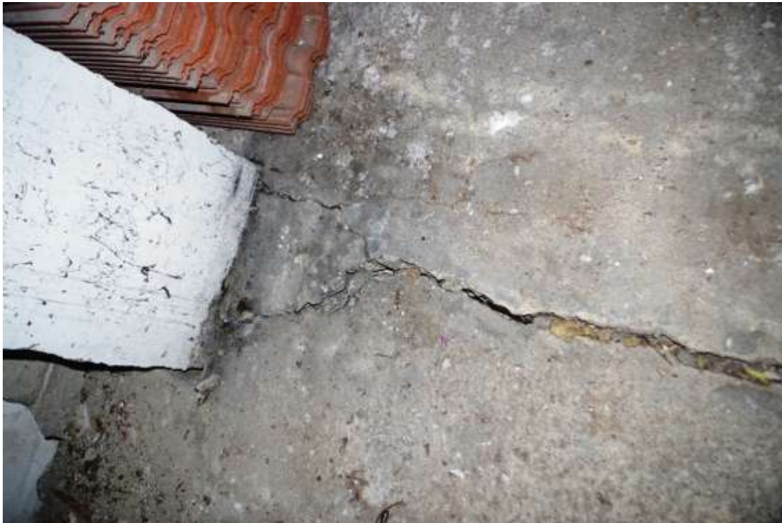
Bild 24: wie vor, Detailansicht Bodenriss
