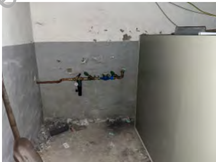
Heizöltankraum Kellergeschoss (Wohnhaus LP Nr. 1)
