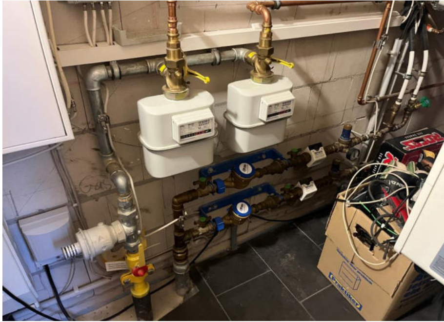
Verteilung im Technikraum EG
