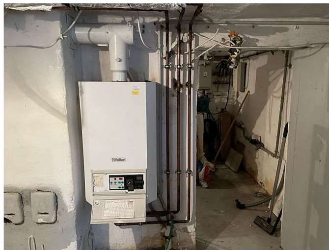
Gastherme im Kellergeschoss
