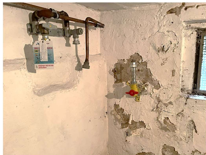
Feuchtigkeitserscheinungen im Kellergeschoss
