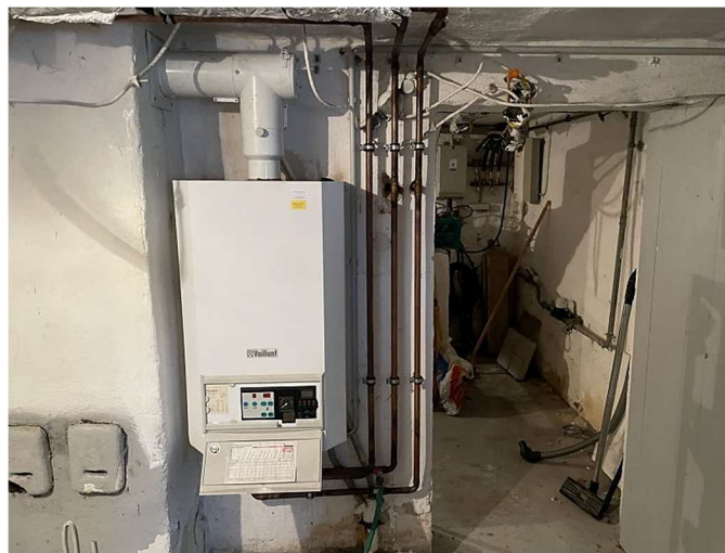
Gastherme im Kellergeschoss
