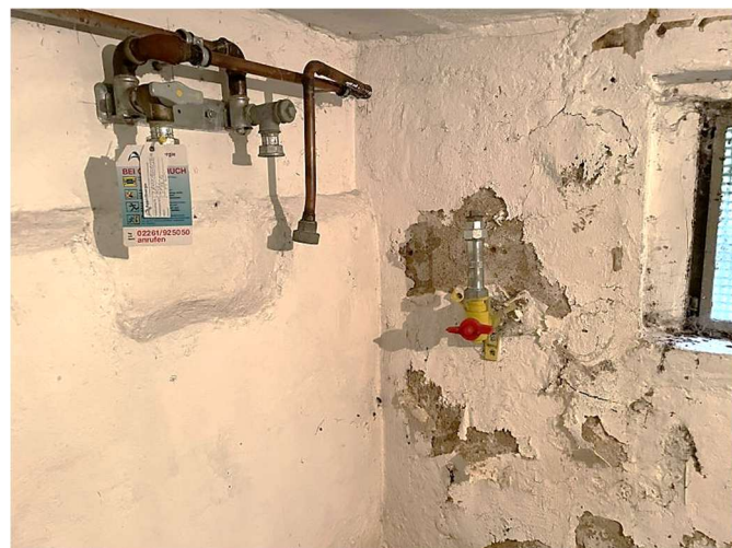
Feuchtigkeitserscheinungen im Kellergeschoss
