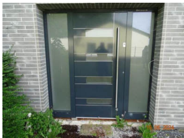
Bild 14 Hauseingangstür, Bodenanschluss fehlt
