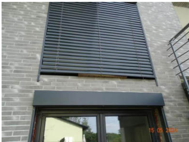
Bild 11 Fensterbank fehlt, Leibungen nicht fertiggestellt
