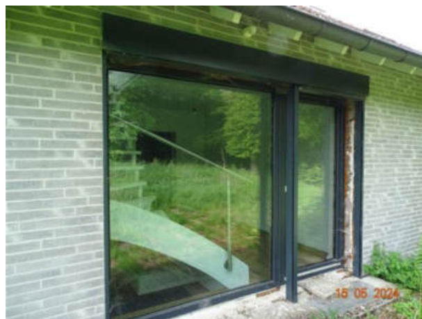
Bild 16 Leibungen nicht fertiggestellt
