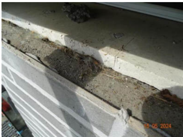
Bild 19 Fehlende Fensterbank, Vorhangfassade hinterläufig
