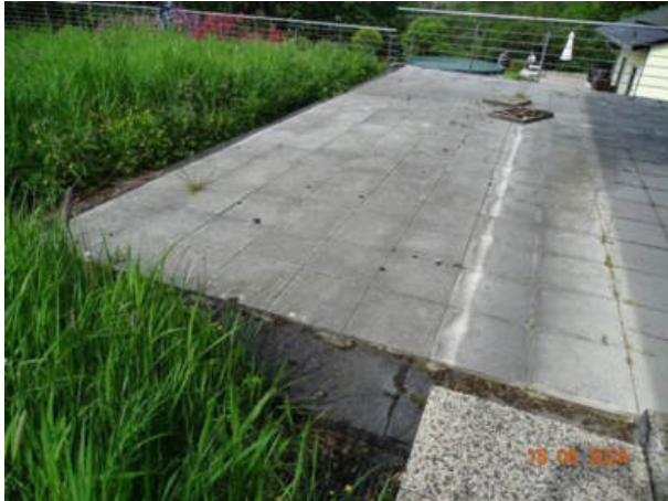
Bild 23 Anschluss zur Anfüllfläche nicht fertiggestellt
