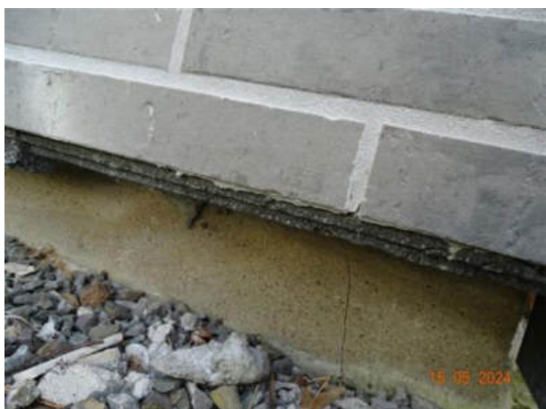
Bild 13 Sockel nicht fertiggestellt
