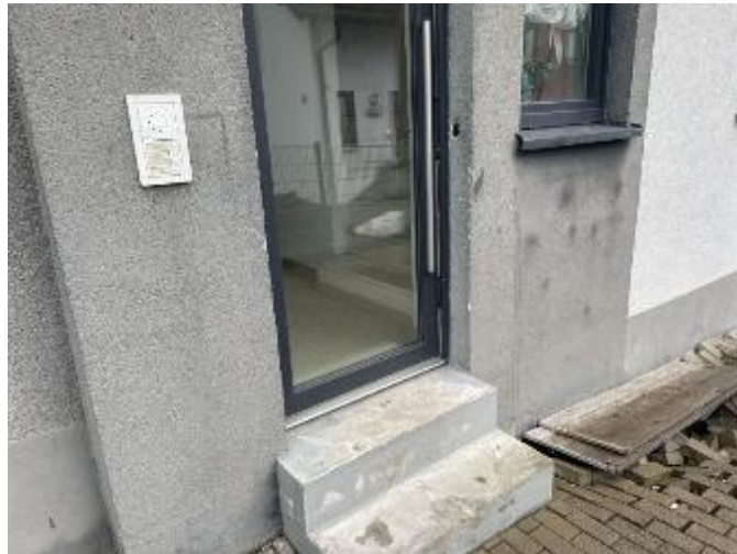
Absackungen im Bereich des Hauseingangs Nr. 7
