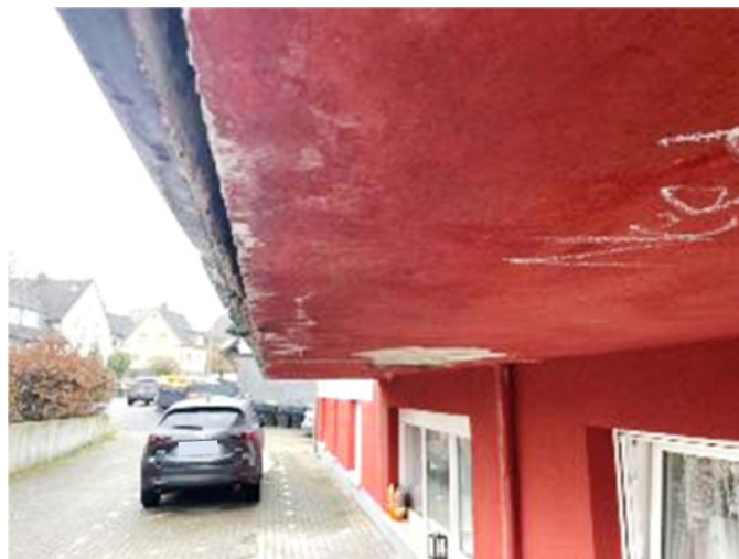
Schäden an den straßenseitigen Balkonen
