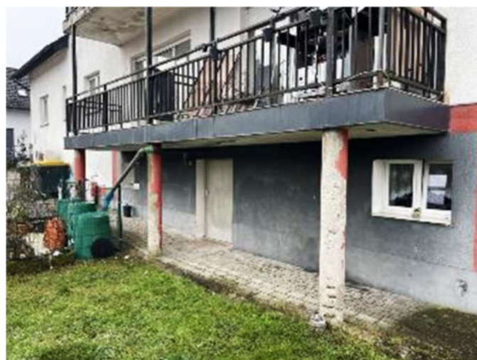
Zuwegung zur Kellereingangstür / Schäden Balkonpfeiler
