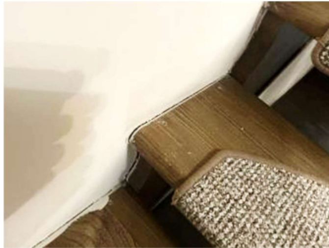
Treppenschaden in der Wohnung im DG links
