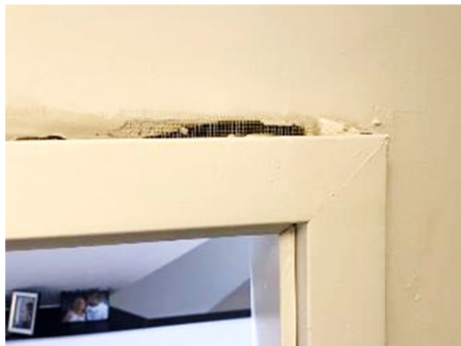
Schaden in der Wohnung Nr. 5 im DG und SB links
