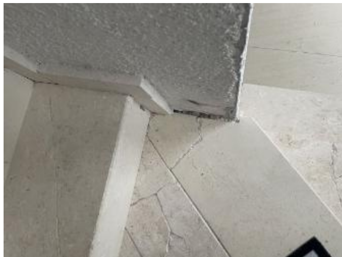
Schäden im Treppenhaus Haus Nr. 7 a
