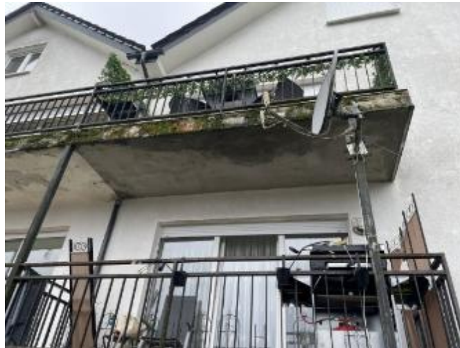
Schäden an den rückseitigen Balkonen
