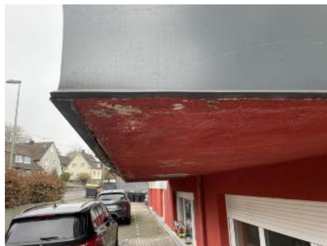
Schäden an den straßenseitigen Balkonen
