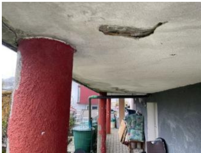
Schäden an den rückseitigen Balkonen
