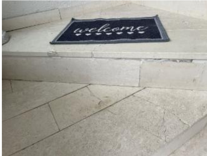
Schäden im Treppenhaus Südring 7 a
