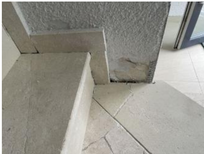
Schäden im Treppenhaus Südring 7 a
