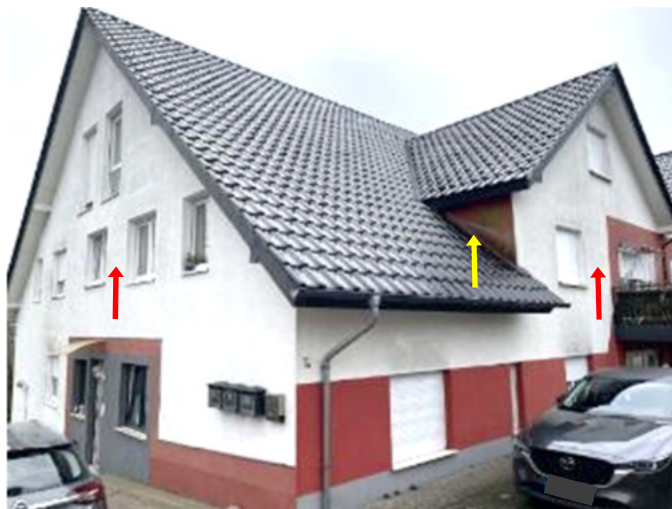
Südring 7 a mit Wohnung Nr. 6 - Feuchtigkeit an Dachgaube
