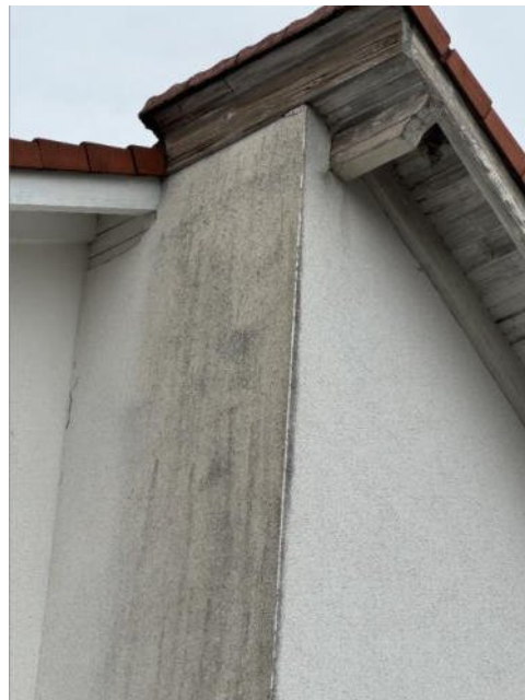
Bild 6: Farbschäden an den Dachüberständen
