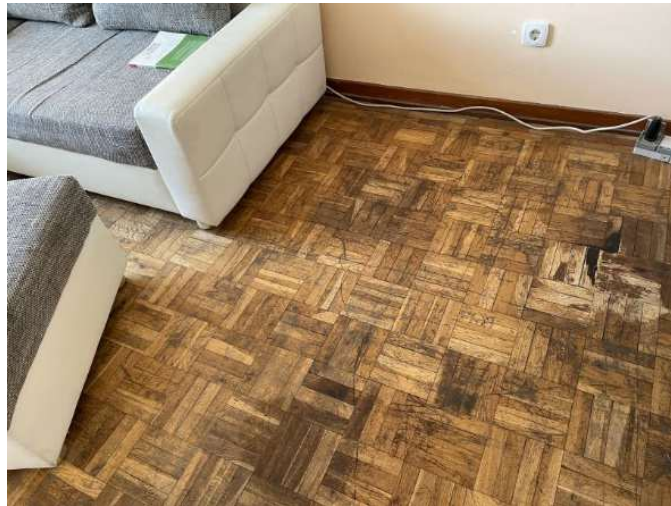
Instandsetzungsbedarf im Erdgeschoss
