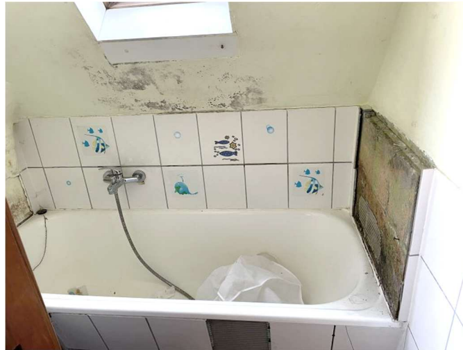
Instandsetzungsbedarf im Dachgeschoss
