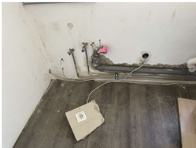
Instandsetzungsbedarf im Dachgeschoss
