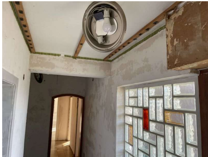
Instandsetzungsbedarf im Erdgeschoss
