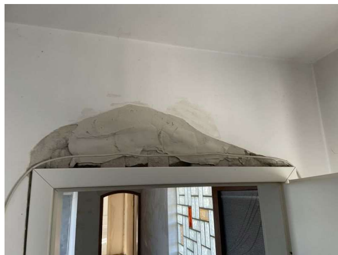
Instandsetzungsbedarf im Erdgeschoss
