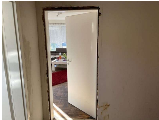
Instandsetzungsbedarf im Erdgeschoss
