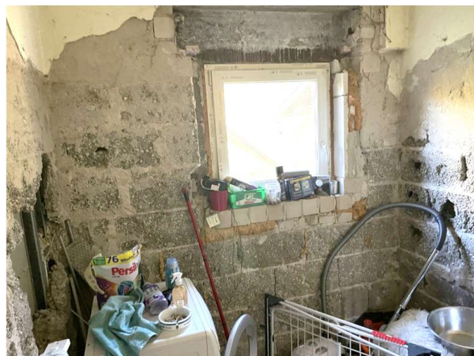
Instandsetzungsbedarf im Erdgeschoss
