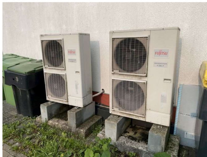
Wärmepumpen für Südring 7 und Südring 7 a
