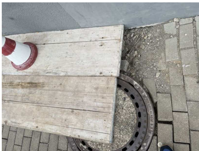
Schaden nach Kanalverstopfung
