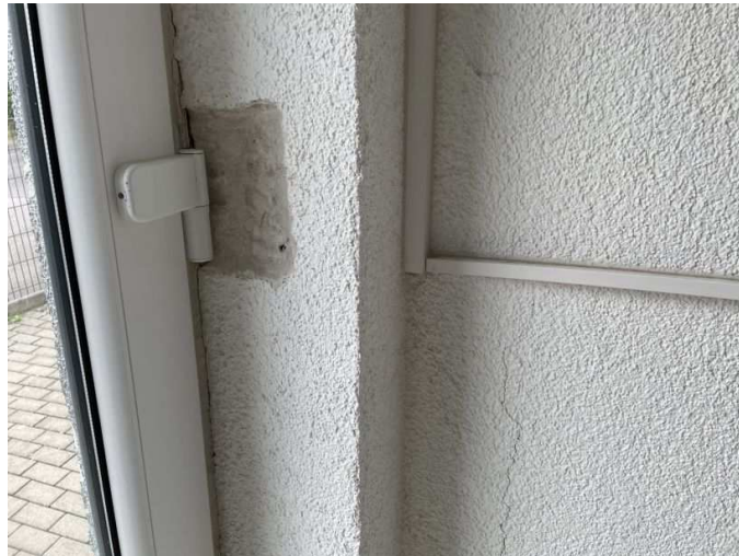
Schaden Hauseingang Südring 7
