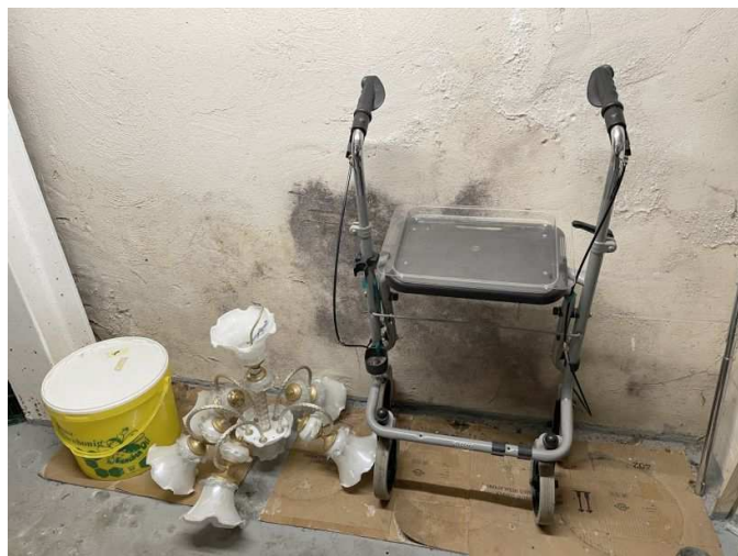
Feuchtigkeitsercheinung im Kellergeschoss
