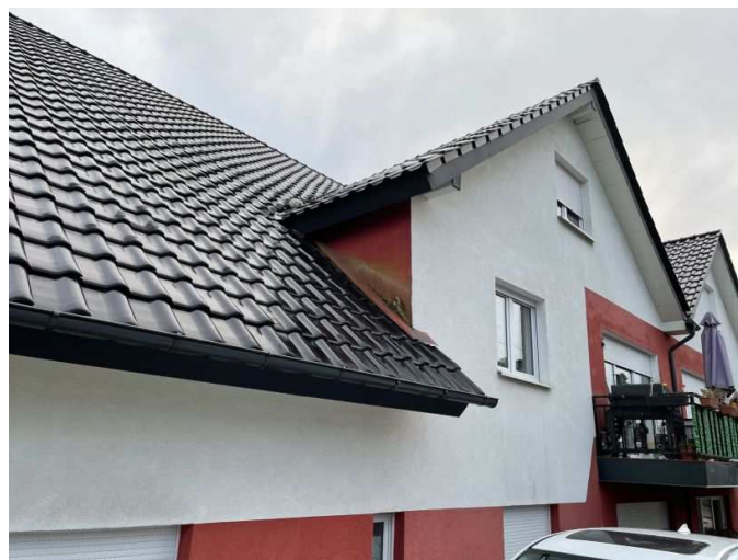
Feuchtigkeitsscheinung an einer Dachgaube
