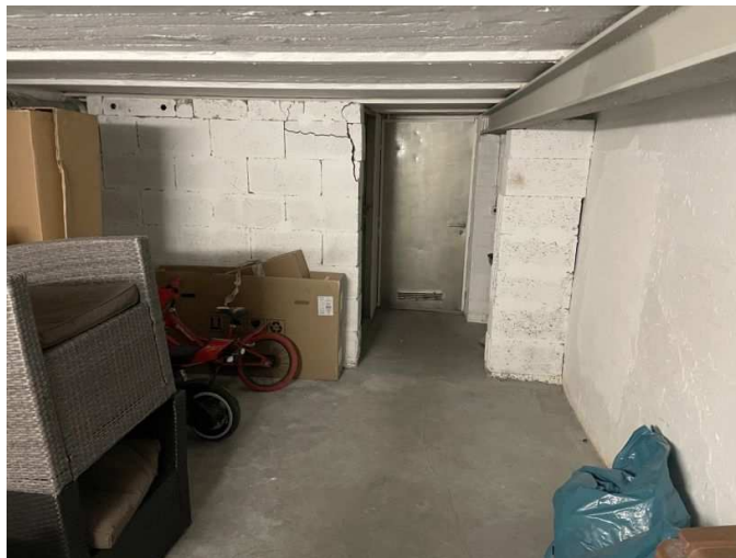
Eingezogene Stahlträger im Kellergeschoss, Schäden
