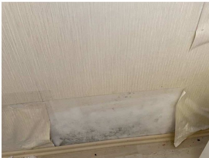
Feuchtigkeitserscheinung in der Wohnung Nr. 4
