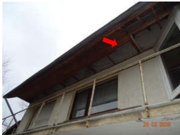
Bild 14 wie vor Holzverkleidung der Traufe fehlt größtenteils
