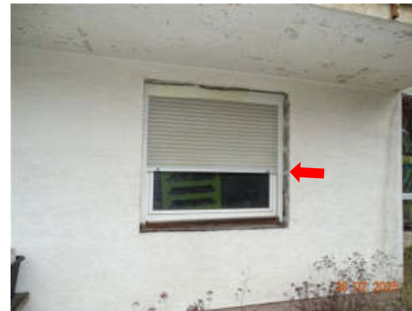
Bild 16 Fensterleibungen nicht fertiggestellt
