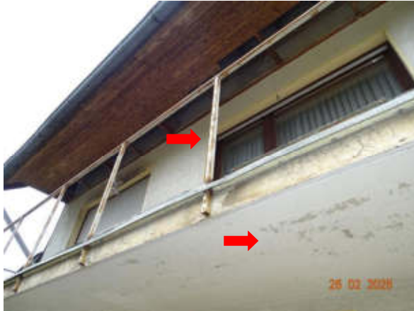
Bild 13 Rückseite Balkonabsturz- sicherung nicht vorhanden Putzabplatzungen
