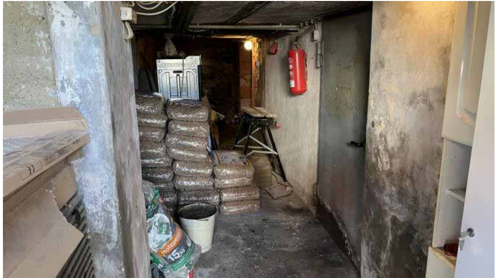
Beispiel Blick in den Keller (Pellet-Lagerung nicht ausreichend trocken)
