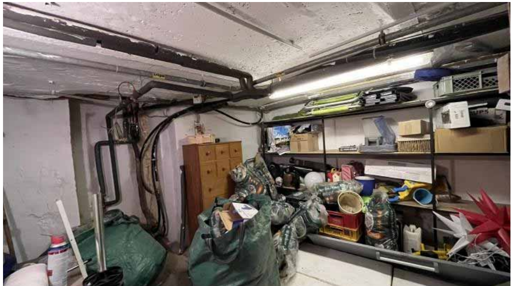
Beispiel Kellerraum (Leitungsführungen tlw. unsauber)
