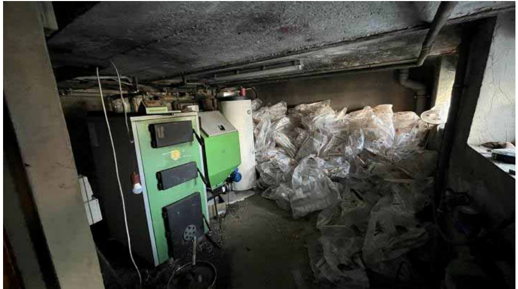
Beispiel Pellet-Heizung mit WW-Speicher (leere Pellet-Säcke)
