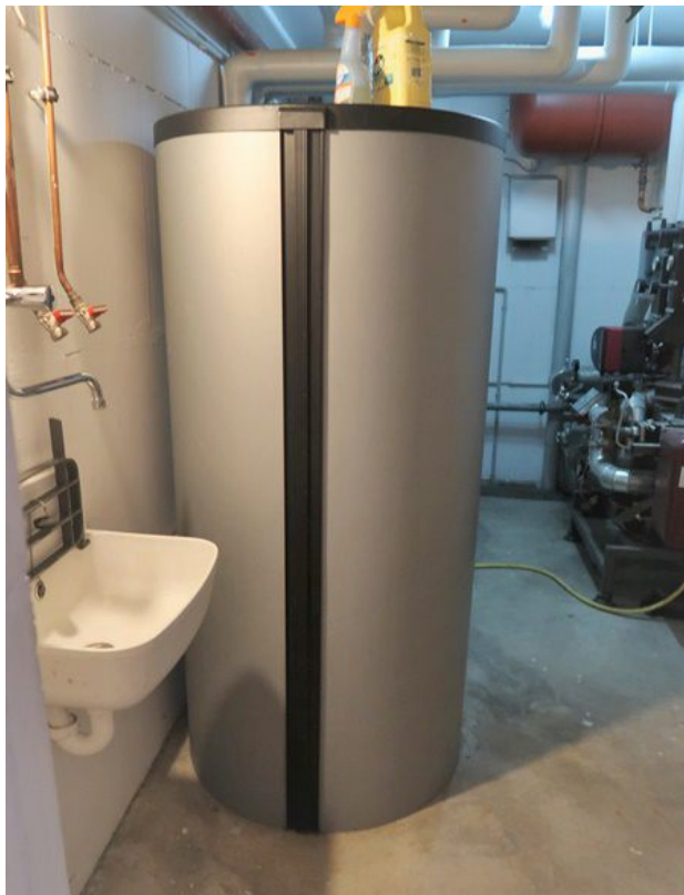
Hausanschlussraum mit Fernwärmeübergabestation und Warmwasser-Standspeicher
