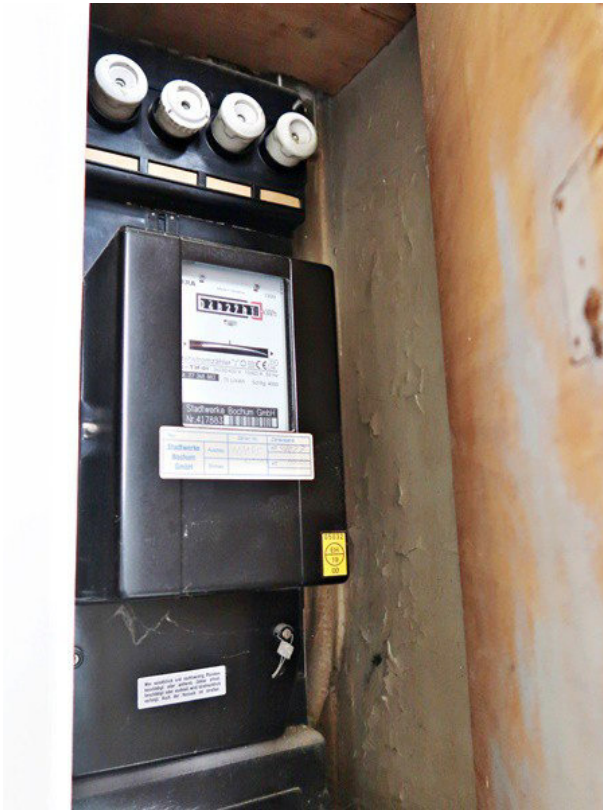
Elektronterverteilung mit Standort im Treppenhaus
