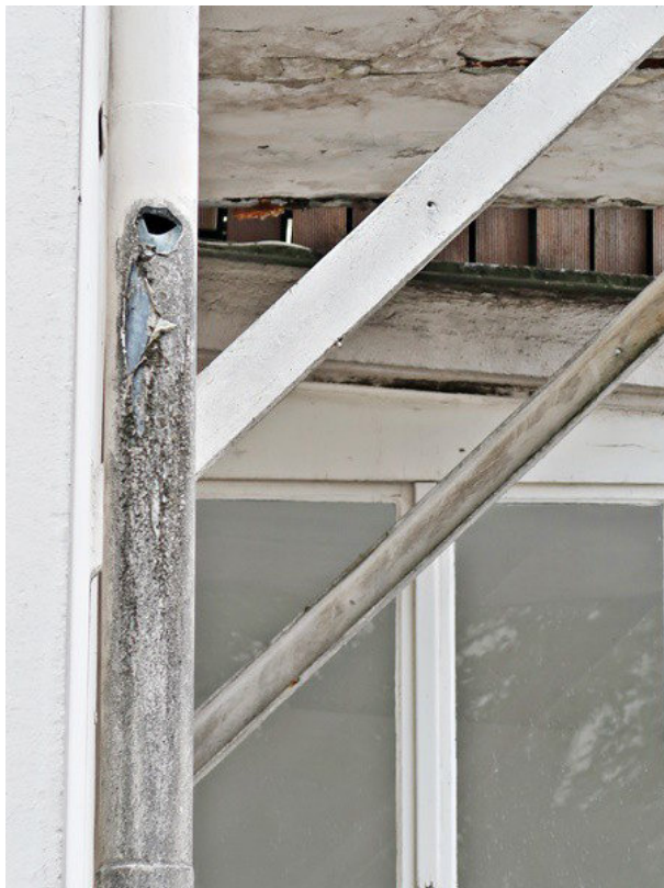
Defektes Fallrohr an der Gebäuderückseite
