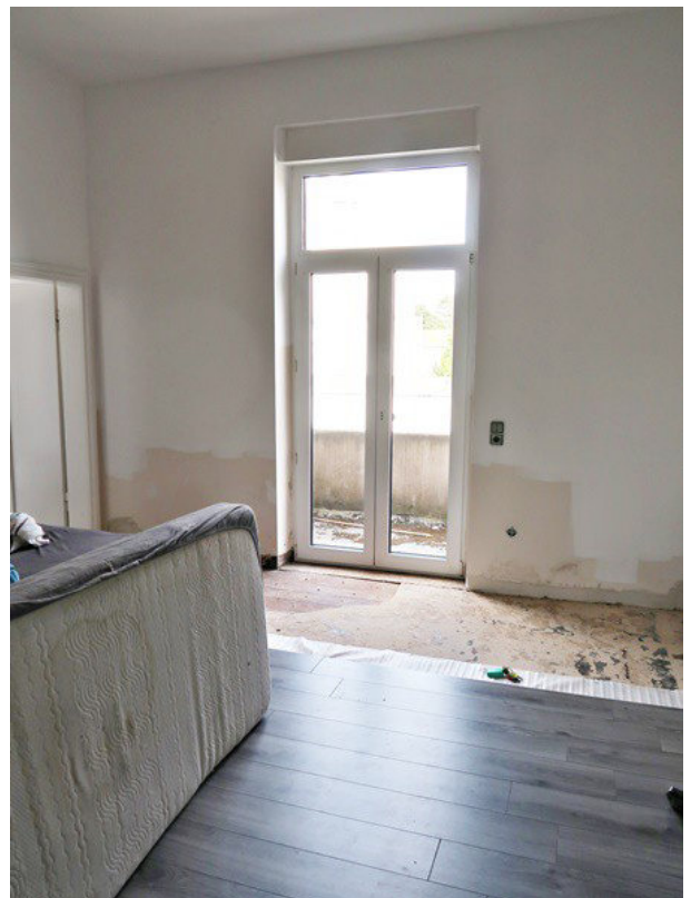
Schlafraum 3 mit Zugang zum Balkon: Feuchteschaden Bodenbelag und angrenzende Wandflächen
