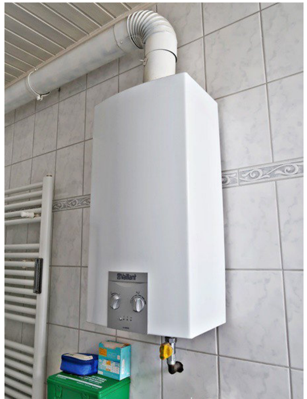
Gastherme zur Warmwasserbereitung
