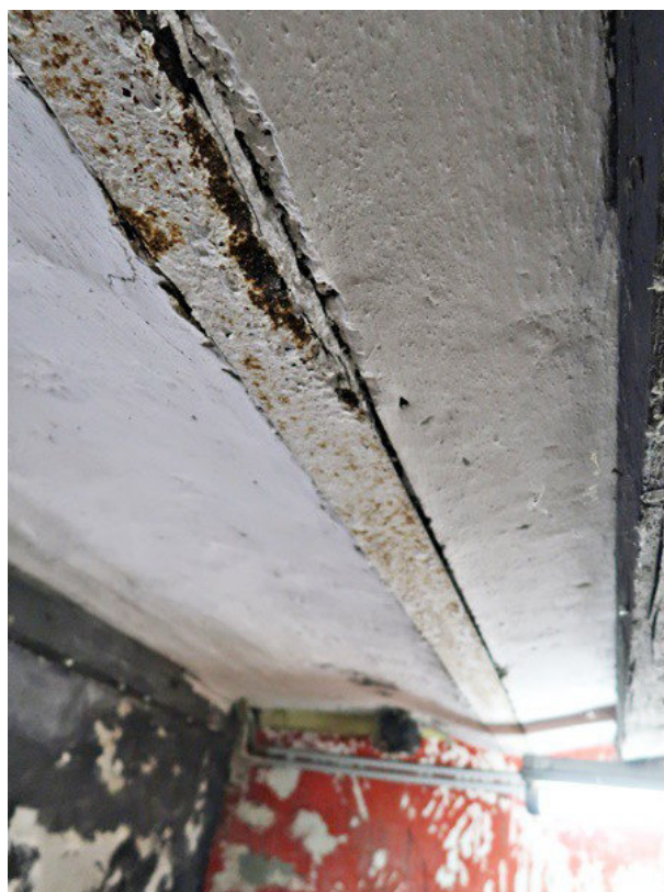
Stahlträger der Kappendecke mit Korrosionsschäden
