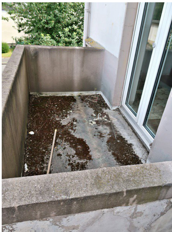
Balkon, wegen Feuchteschäden derzeit nicht mehr nutzbar
