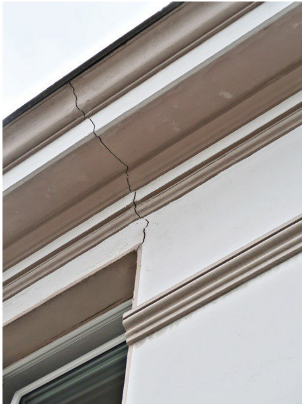
Risschaden im Bereich der Traufe an der Gebäuderückseite
