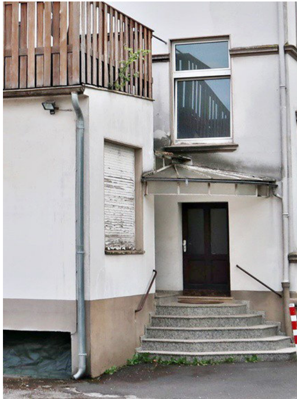
Verfärbungen im Bereich der Überdachung Hoftür
