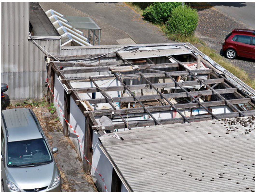
Reihengaragenanlage, Dachkonstruktion teilweise zerstört
