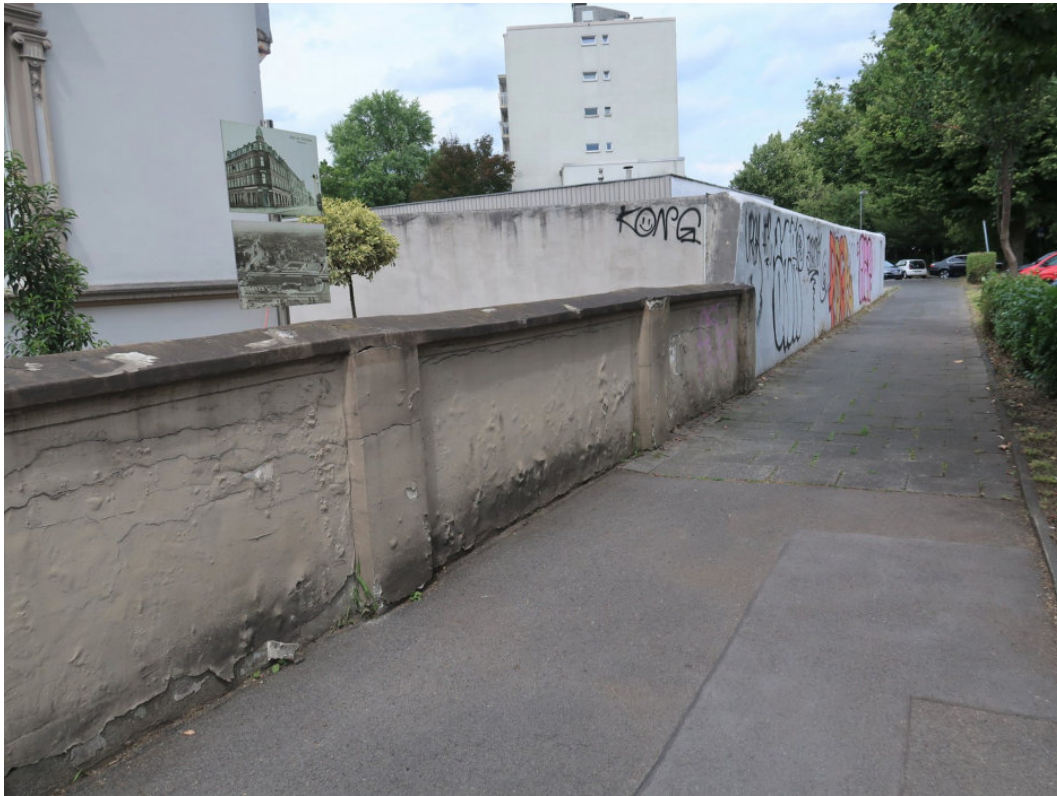
Mauer der Grundstückseinfriedung mit Putzschäden
