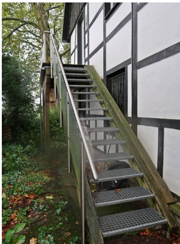
Außentreppe zur Einliegerwohnung mit Verfärbungen und Verwitterungsanzeichen
