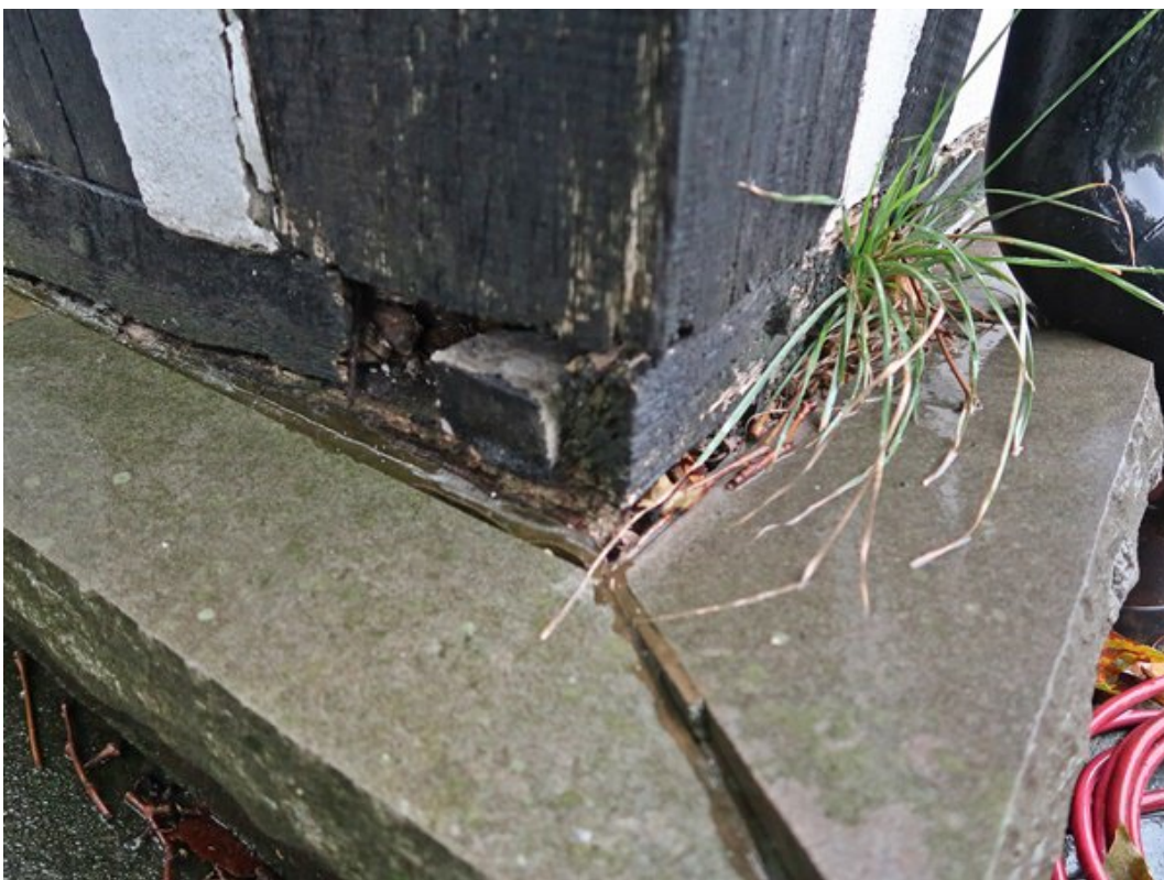
Teilansicht Fassade mit Fehlstelle im Konstruktionsholz
