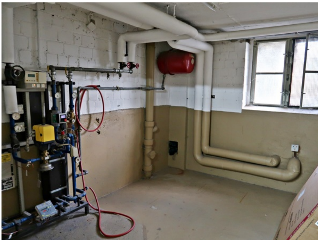
Heizungsraum mit Fernwärmeübergabestation
