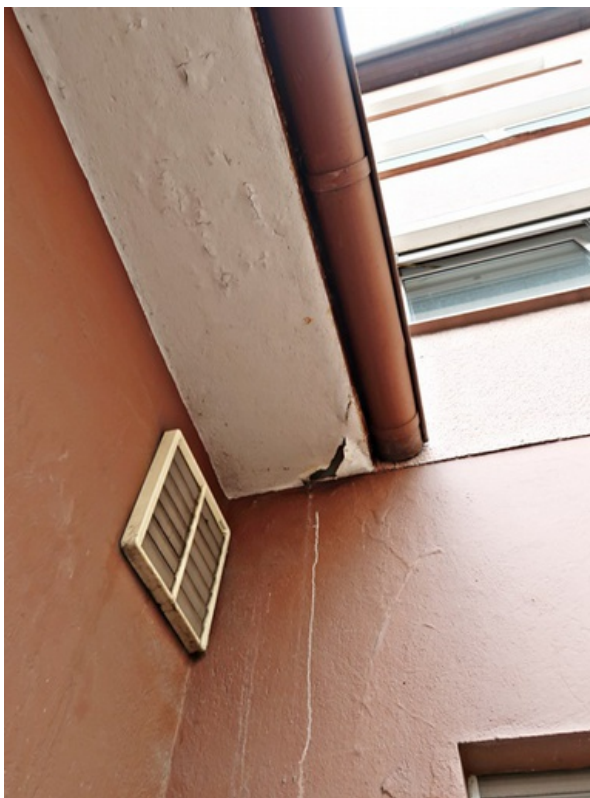
Putzschäden und Abplatzungen Untersicht Flachdachanbau
