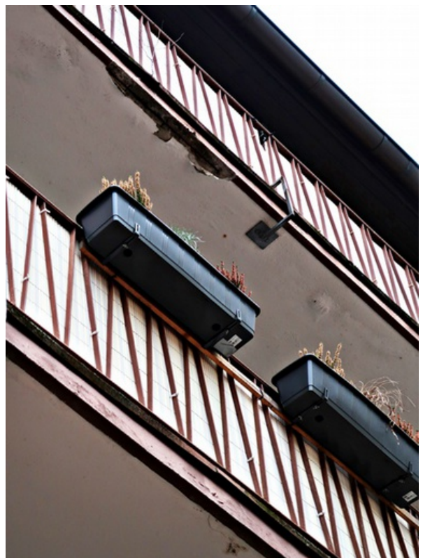
Untersicht Bodenplatte Balkon mit Abplatzungen
