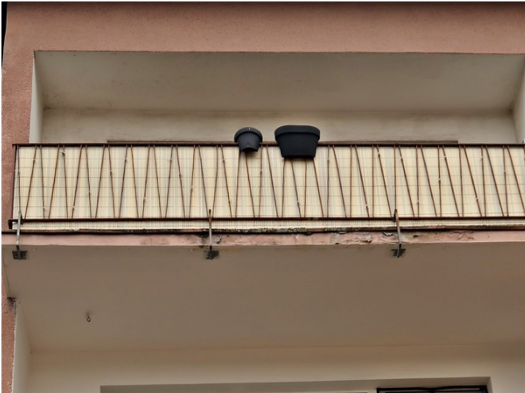
Rissschäden und Abplatzungen Vorderkante Bodenplatte Balkon
