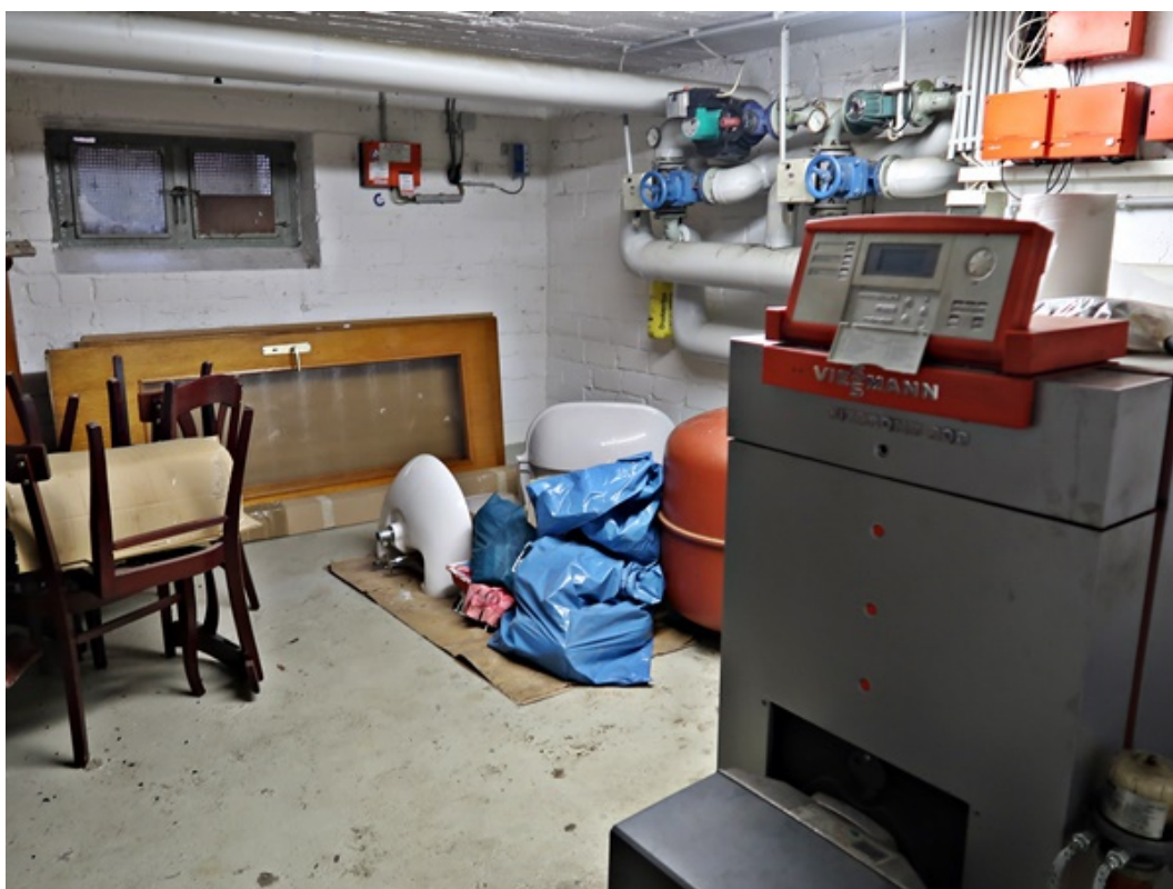
Heizungsraum mit Ölheizkessel
