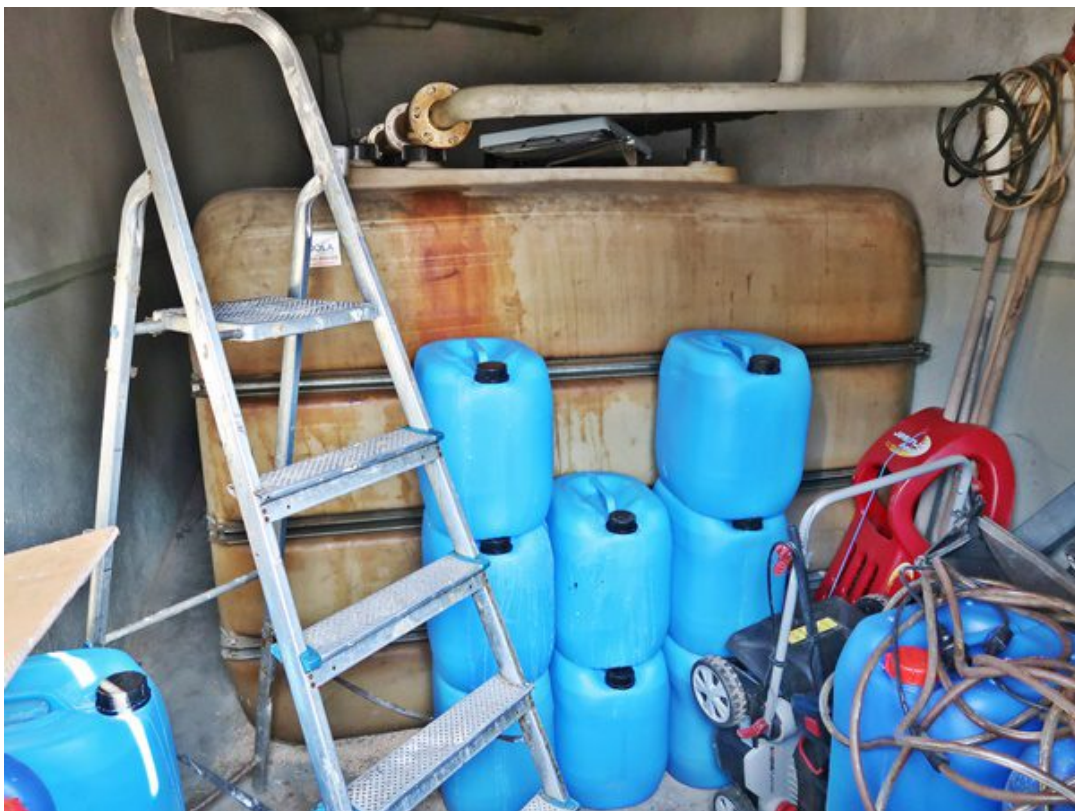
Heizöltank in separatem Raum unter der Terrasse Erdgeschoss mit Zugang vom Hof
