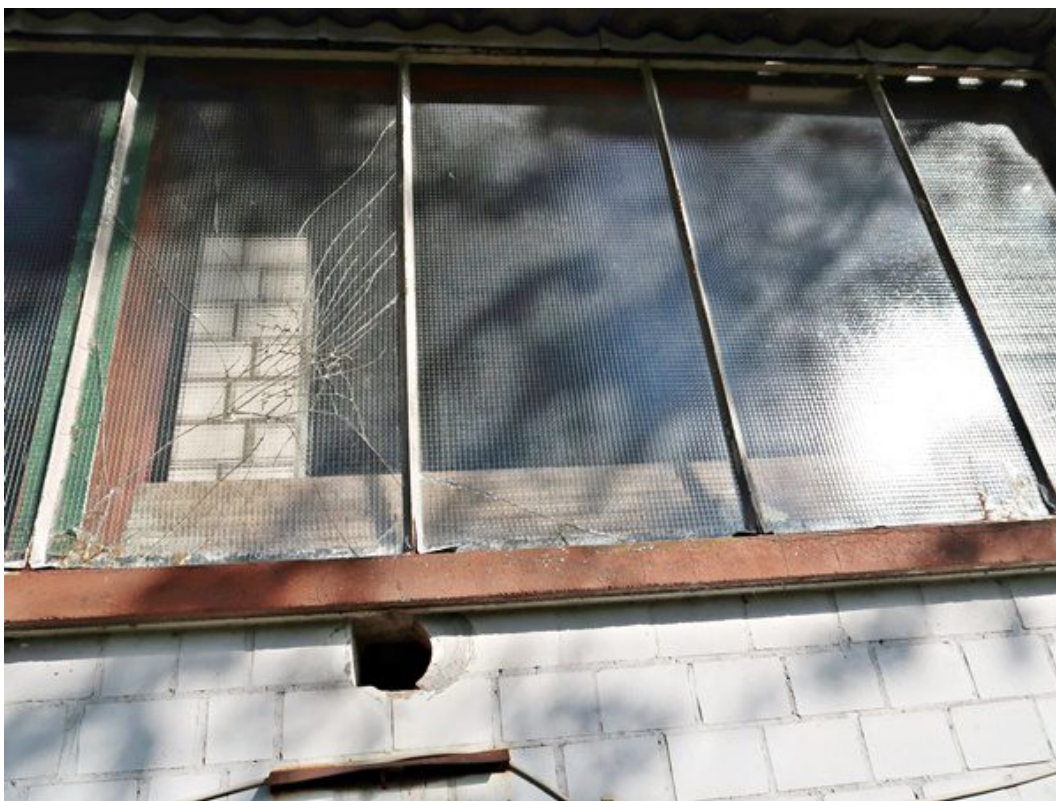
Teilansicht beschädigte Festverglasung
