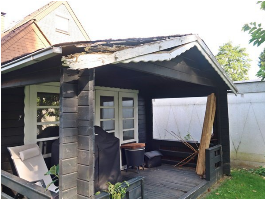
Gartenhaus mit Schäden am Dachüberstand und Bodenbelag
