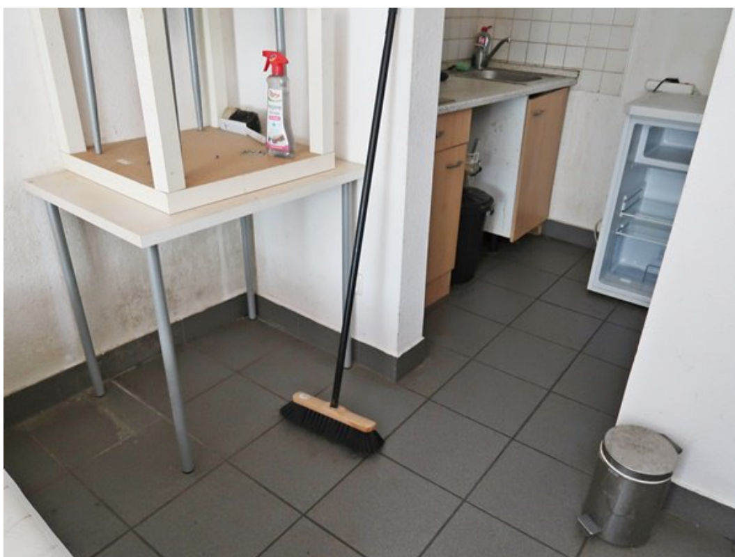
Feuchteschäden mit Schimmelpilzbefall
