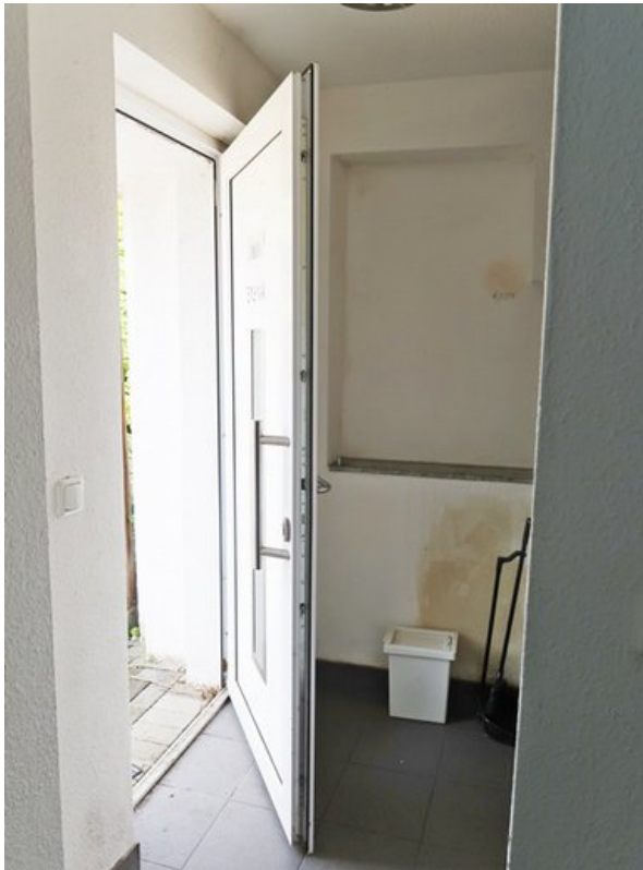
Appartement 3, bauordnungsrechtlich ebenfalls nicht genehmigt, mit erheblichen Feuchteschäden und Schimmelpilzbefall
