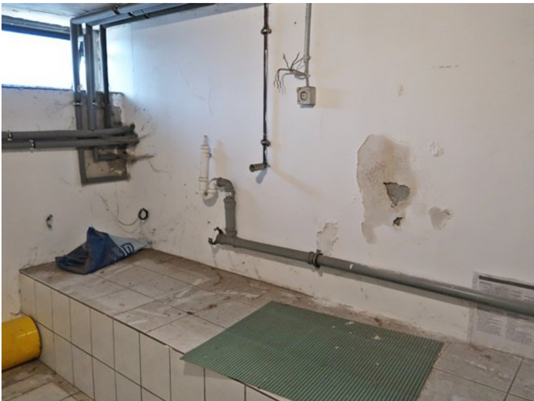
Teilansicht Waschküche mit Feuchteschäden Wandfläche
