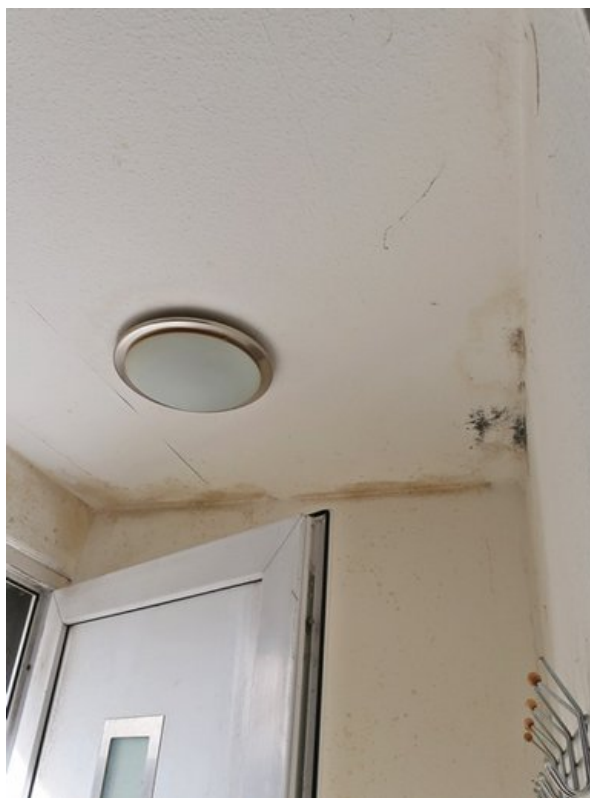
Feuchteschäden mit Schimmelpilzbefall
