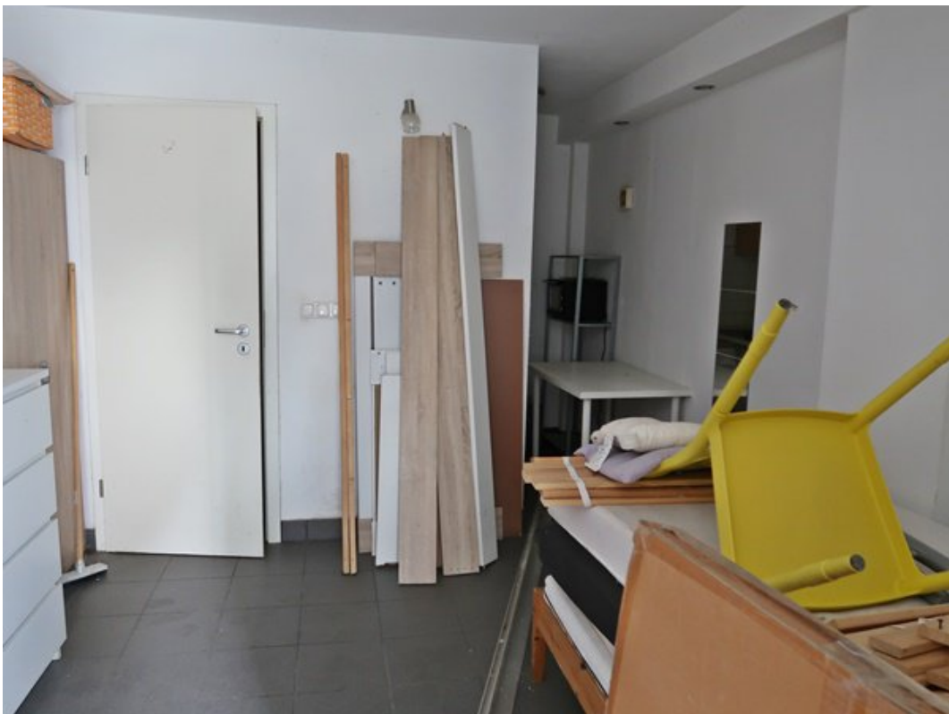
Hofgebäude: Appartement 1, Ausbau und Nutzung bauordnungsrechtlich nicht genehmigt
