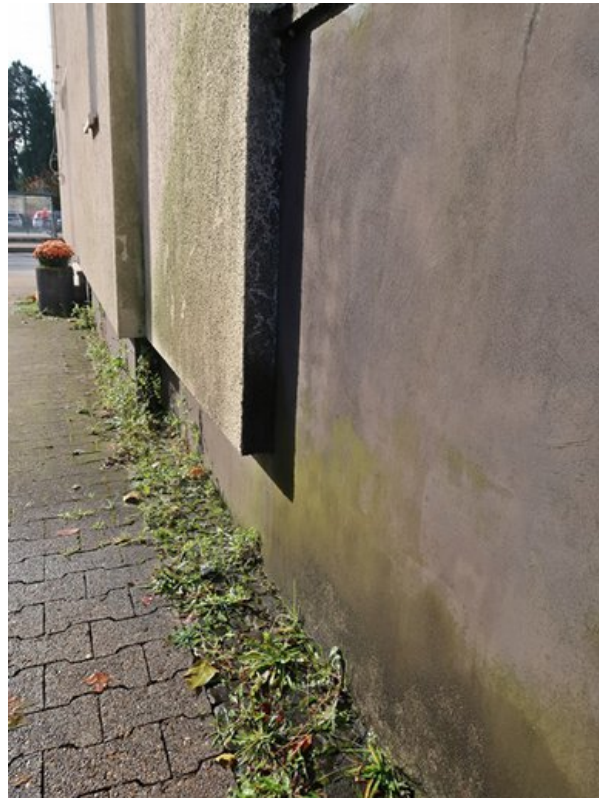
Fassade Mehrfamilienhaus mit erheblichen Verfärbungen
