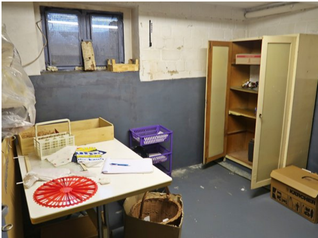
Kellerraum mit Feuchteanzeigen Boden- und Wandfläche
