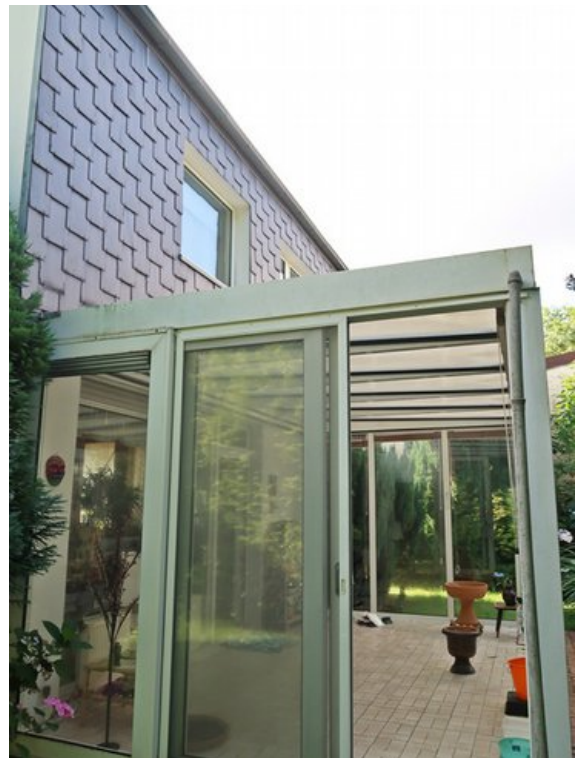
Seitenansicht mit Wintergarten, bauordnungsrechtlich nicht genehmigt, vgl. Ziffer 4.4.
