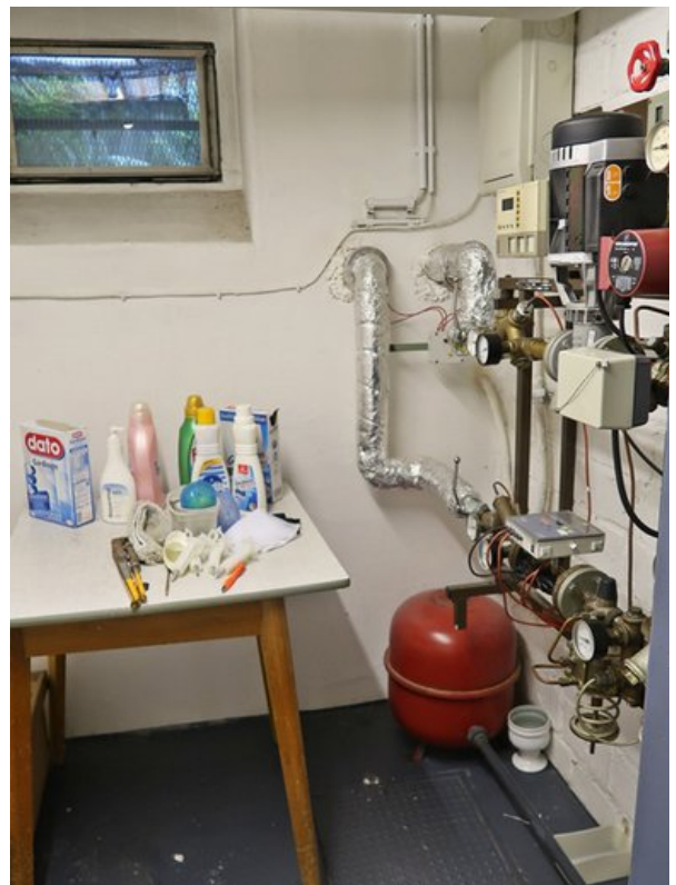
Kellerraum mit Fernwärmeübergabestation
