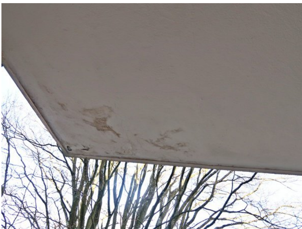
Feuchteschaden mit Abplatzungen Untersicht Loggia 2. OG
