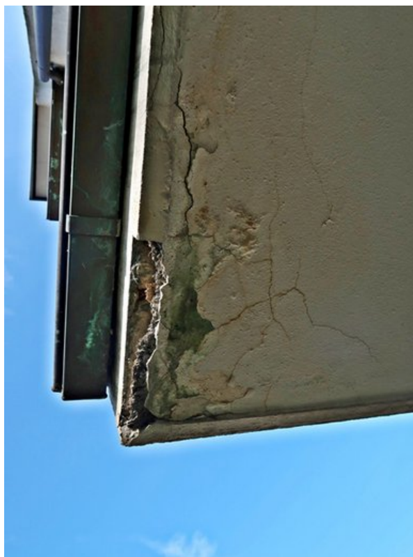
Risschäden mit Abplatzungen an der Loggia Untersicht 2. OG
