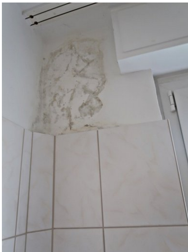
Feuchteschaden Außenwand Bad
