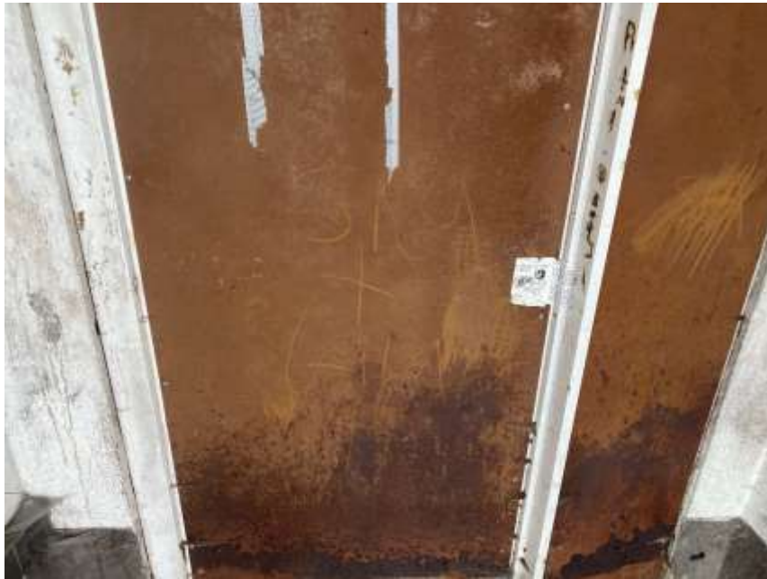
Bild 11: Versiegelte Bautür durch die Taskforce
