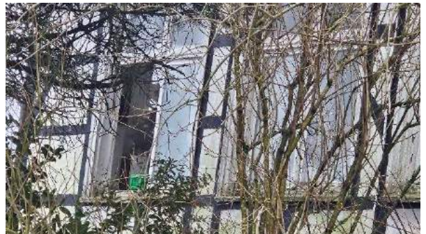
Abb. 4: Defektes Fenster Anbau
