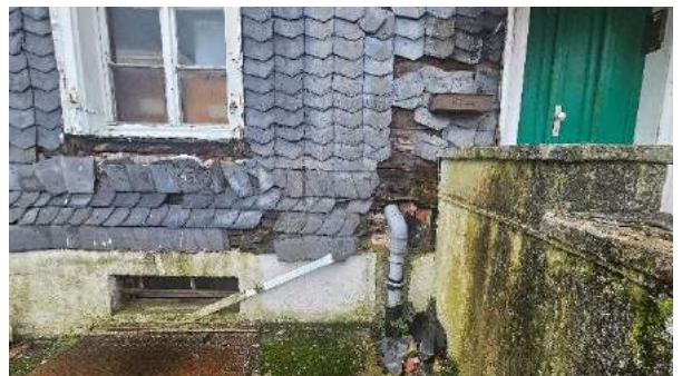
Abb. 6: Defekte Fassade und Fensterbänke
