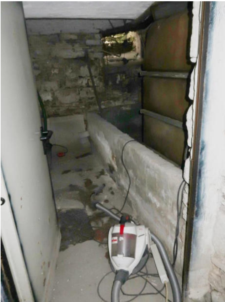
Öltank nicht mehr genutzt
