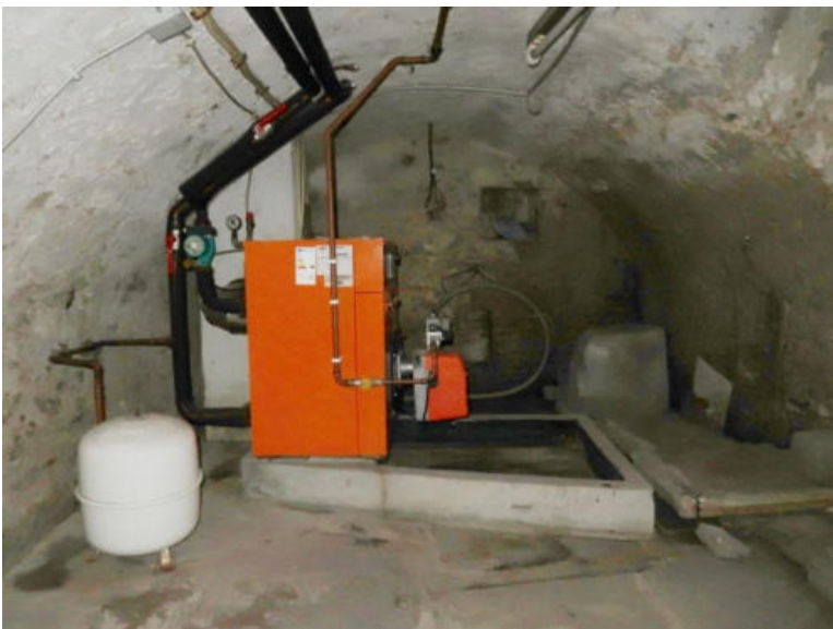
Gewölbekeller mit Heizungsanlage
