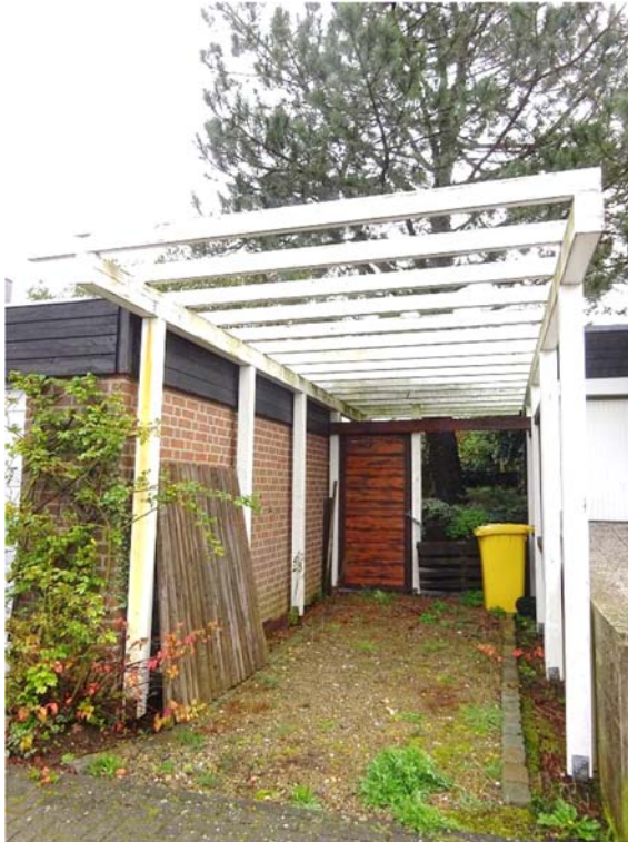
Carport ohne Eindeckung (Witterungsschäden)
