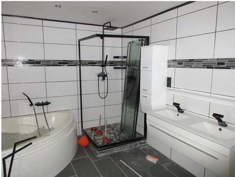
Bad, Einbauten schadhaft, Feuchteschaden um Spot
