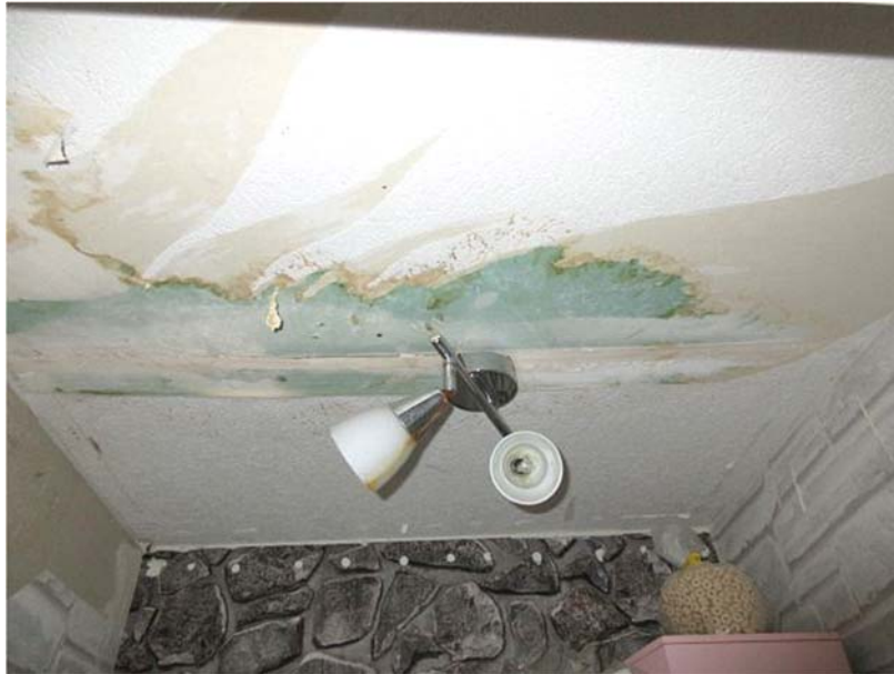
Decke Abstellraum, ggf. Feuchteschaden
