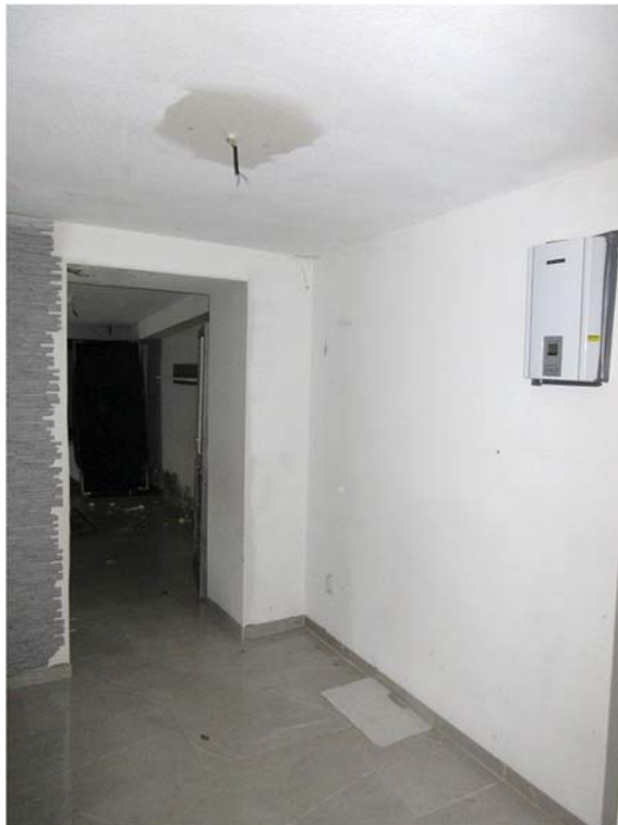
Durchgangszimmer / Flur, ohne Belichtung
