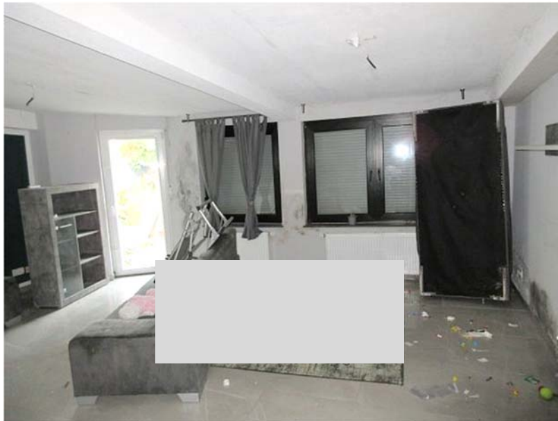
hinterer Anbau / Wohnen, Feuchteschäden
