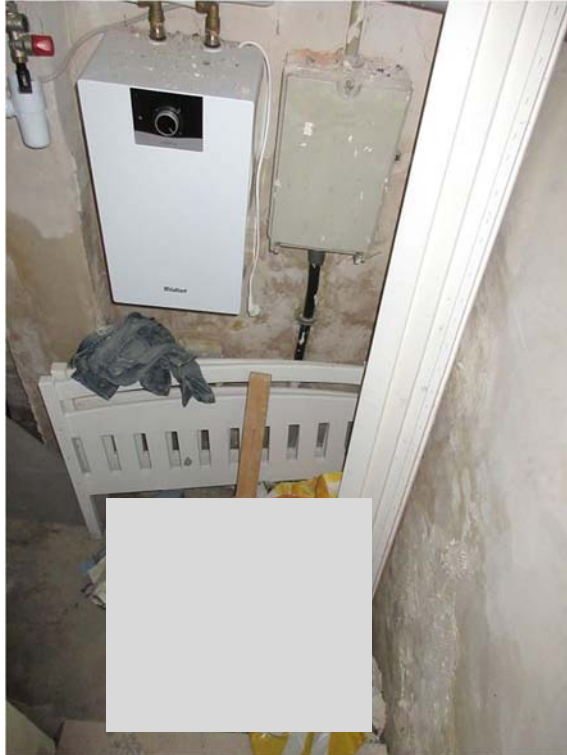
Außenecke vorne, Feuchteschaden
