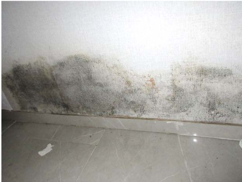
Schimmelschäden Sockelbereich Seitenwand
