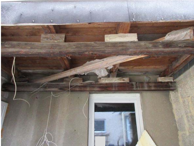
Anbaunische, Balken schadhaft
