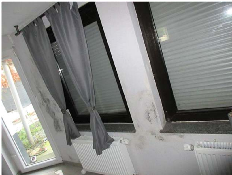
Schimmelschäden Türlaibung und Fensterbrüstung
